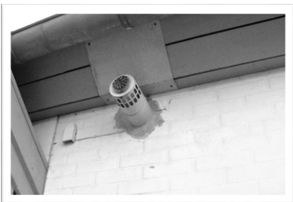
EX 11.12. Balanceret aftræk fra gasfyr. Der er risiko for skader som følge af kondens, fordi afkastluft kan trænge ind i tagkonstruktionen via udhænget. (Foto: Aktuel Bygge Rådgivning)
