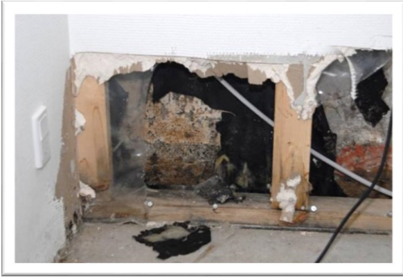
EX 5.5. Skimmelvækst på oprindelig kældervæg og på træskelet (uimprægneret). I dette tilfælde skyldes skimmelvæksten på væggen fugt udefra. (Foto: Erik Brandt)
