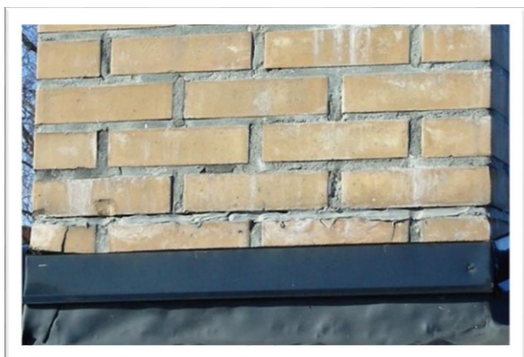
EX 1.22. Fuge udført med fugemasse – stenen på hjørnet er knækket. (Foto: Aktuel Bygge Rådgivning)
