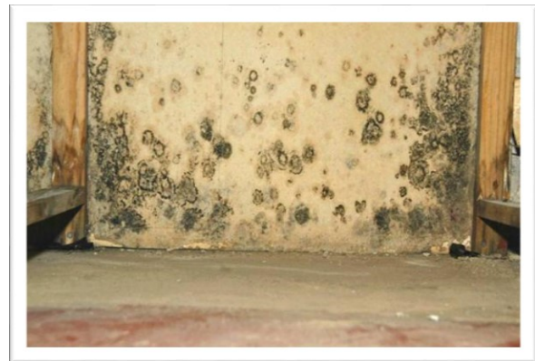
EX 5.4. Skimmelvækst på tapetseret kælderydervæg pga. opfugtning, forårsaget af defekt dræn. (Foto: Erik Brandt)
