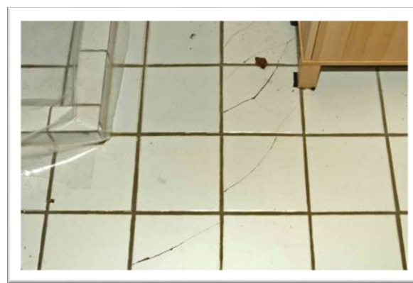
EX 6.9. Gennemgående fuger kan være tegn på skader i underlaget – her råd i en træplade. (Foto: Erik Brandt)
