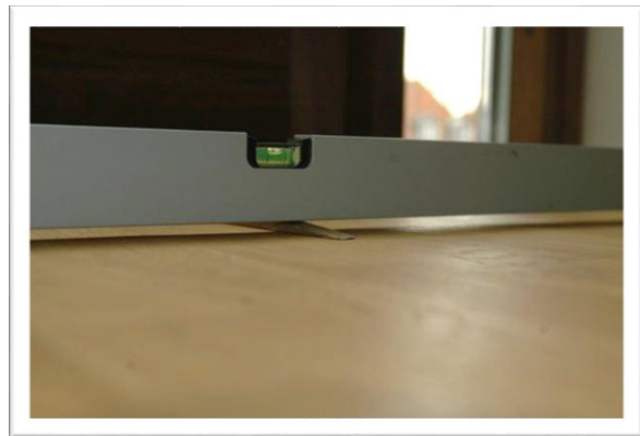
EX 7.4. Manglende planhed af trægulv. (Foto: Erik Brandt)
