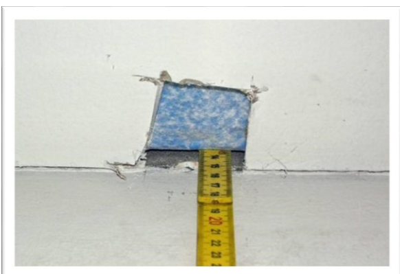
EX 9.3. Manglende tilslutning af dampspærre mod væg. (Foto: Erik Brandt)
