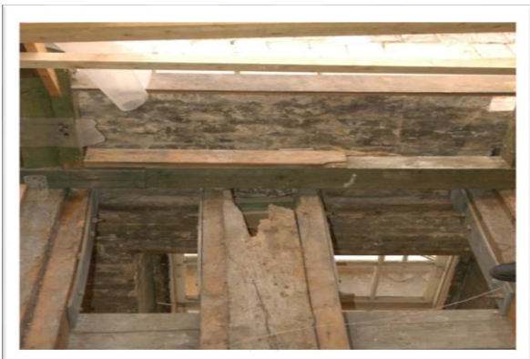
EX 9.1. Bortrådnede bjælkeende i træbjælkelag pga. utæthed ved tagfod. (Foto: Erik Brandt)
