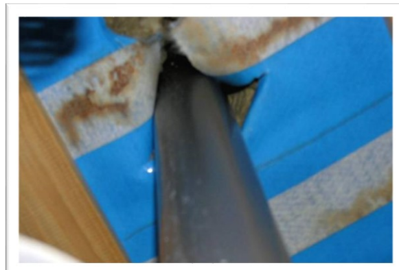
EX 9.2. Utæthed omkring gennemføring i dampspærre medfører risiko for opfugtning af tagkonstruktionen pga. konvektion af fugtig rumluft. (Foto: Erik Brandt)
