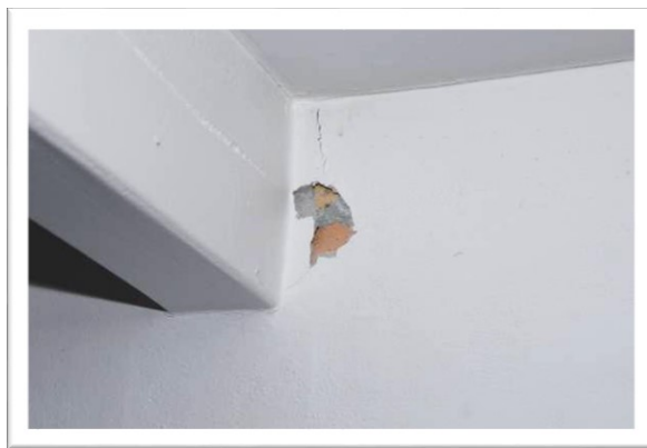
EX 8.2. Skade på væg som følge af overbelastning fra bjælke. (Foto: Erik Brandt)
