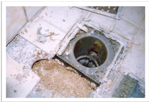
EX 11.1. Nedbrudt gulv pga. gulv afløb, som ikke er korrekt monteret. (Foto: Erik Brandt)
