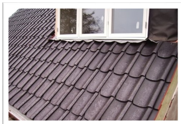
EX 1.10. Inddækning under kvist er ikke udført, så vandafledning sikres. (Foto: Aktuel Bygge Rådgivning)
