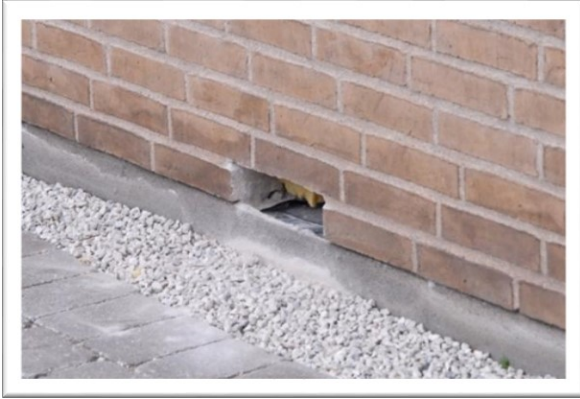
EX 2.1. Opfugtning af facaden, fordi murpappen ikke er ført frem til forkanten af facaden. Der må ikke pudses hen over murpappen, fordi pudsen virker som en væge, der kan trække fugt op. (Foto: Erik Brandt)
