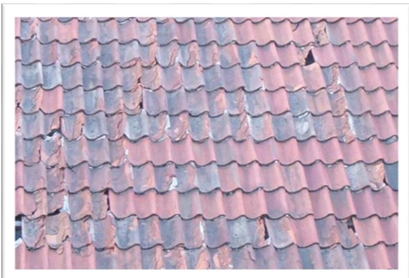
EX 1.1. Nedbrudte tagsten – levetid udtømt. (Foto: Erik Brandt)
