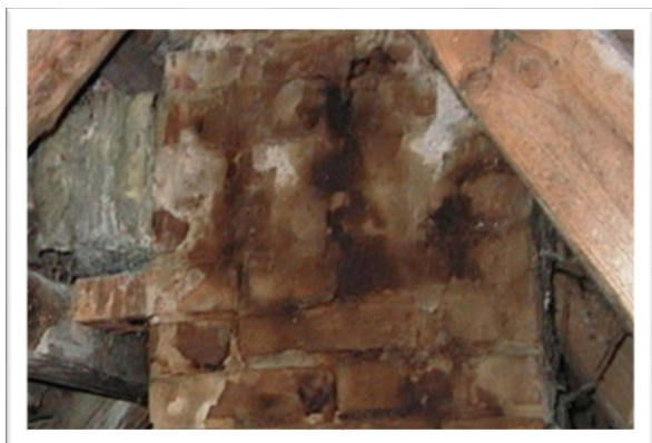
EX 1.24. Løbesod på skorsten indikerer, at der kan være problemer med fugtindtrængning og/eller dårlig forbrænding. Her vurderes ud fra, om skorstenen er i brug eller ej. (Foto: Peter Olsson)
