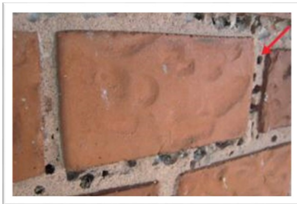
EX 2.3. Fuger angrebet af murbier, hullerne (vist ved rød pil) er 5-6 mm i diameter. (BYG-ERFA)
