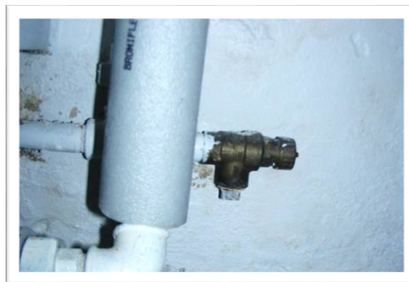
EX 11.6. Afproppet sikkerhedsventil, hvilket forårsager fare! Iht. AT-vejledning og vandnormen må sikkerhedsventiler ikke afproppes, men skal nedføres farefrit over recipient og på en sådan måde, at utilsigtet afspærring ikke umiddelbart kan ske, fx med skråt afskåret rør. (Foto: Aktuel Bygge Rådgivning)
