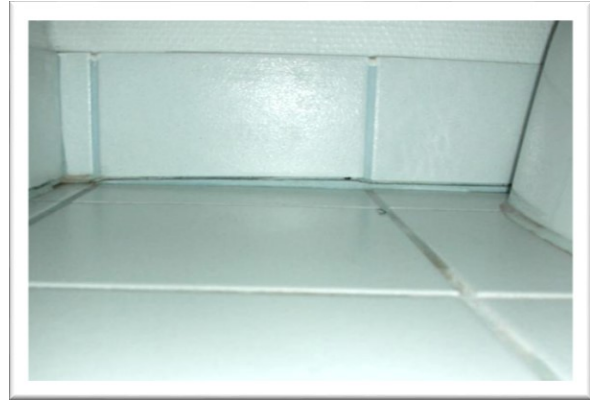
EX 6.11. Sætninger i golvpladen, fuger slipper. (Foto: Aktuel Bygge Rådgivning)
