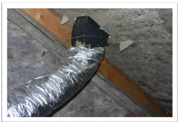
EX 1.7. Ukorrekt udført gennemføring i undertag af gipsplade samt skimmelvækst på pladens overflade. (Foto: Erik Brandt)
