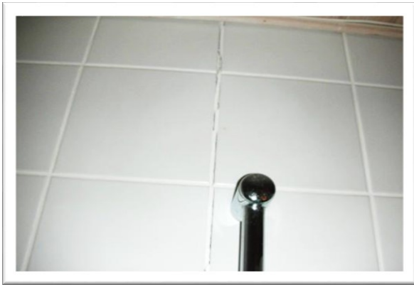
EX 6.10. Flisefuger er revnede, her som følge af stabilitetssvigt i vægkonstruktion. (Foto: Aktuel Bygge Rådgivning)
