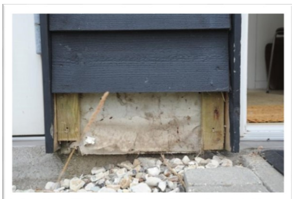
EX 2.5. Nedbrydning af let facade, fordi vindtæt afdækning (gipsplade) og beklædning er afsluttet for tæt på terræn. (Foto: Erik Brandt)
