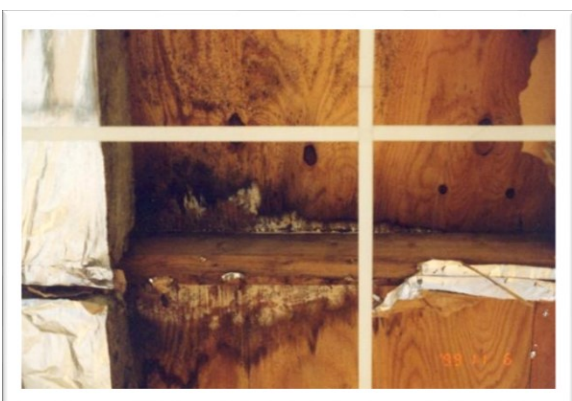
EX 1.11. Skimmelvækst på tagunderlag pga. defekt dampspærre. (Foto: Erik Brandt)
