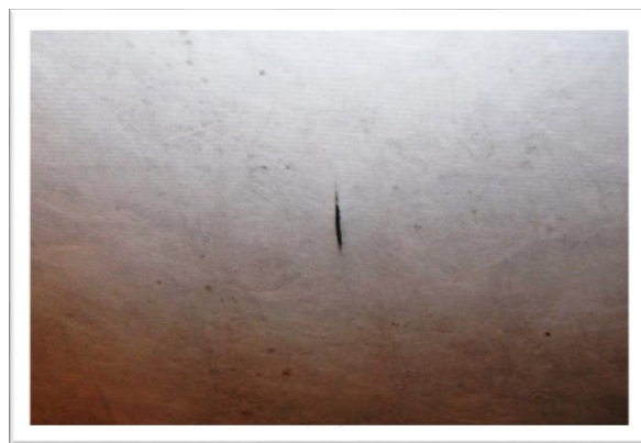
EX 1.8. Hul efter binder i undertag – tætheden er ødelagt ved binderen pga. blafring. (Foto: Erik Brandt)
