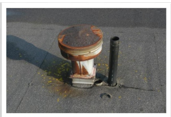
EX 1.13. Ukorrekt udførte gennemføringer – for tæt sammen til, at samlinger kan udføres korrekt. (Foto: Erik Brandt)
