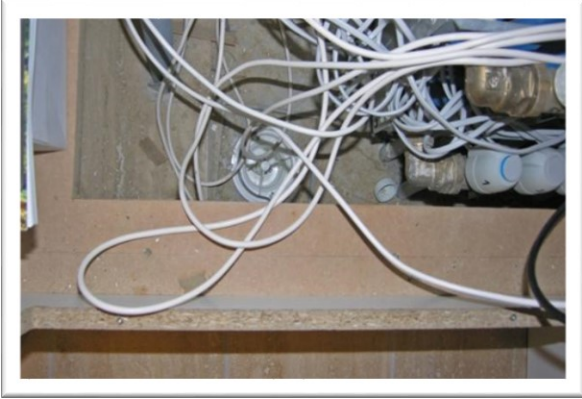
EX 11.3. Gulvfløb placeret svært tilgængeligt i bunden af et skab. (Foto: Erik Brandt)
