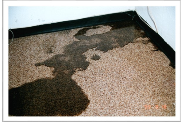
EX 5.2. Vandindtrængning i ældre kælder under regnvejr. Kældre må altid forventes at være tætte mod vand fra almindelig nedbør – ellers skal ejeren oplyse det. (Foto: Erik Brandt)
