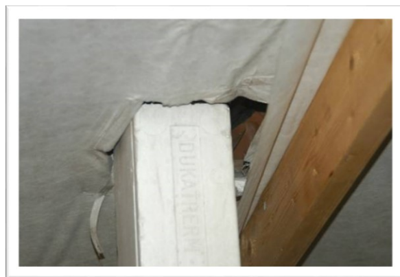
EX 1.6. Forkert udført gennemføring. Underlag mangler og samlingen er ikke tæt. (Foto: Erik Brandt)
