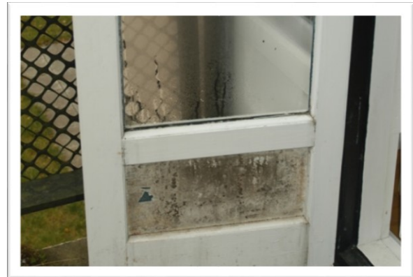
EX 3.4. Kondens på glas i yderste ramme ved dør med forsatsramme. (Foto: Erik Brandt)
