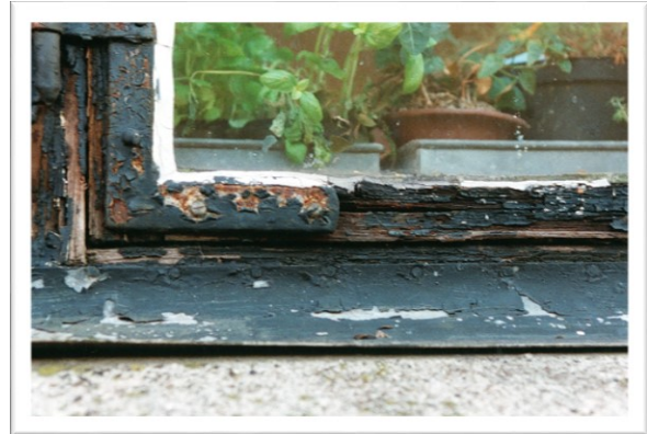
EX 3.2. Hvis vedligeholdet negligeres, vil træet blive helt nedbrudt. (Foto: Erik Brandt)
