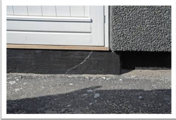
EX 4.1. Revne i sokkel pga. last fra forvæg. (Foto: Erik Brandt)
