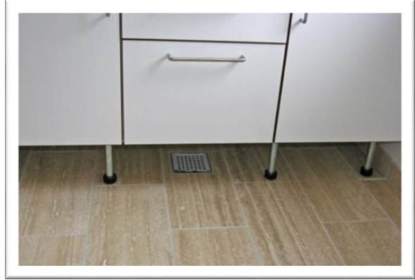
EX 11.4. Gulvfløb monteret svært tilgængeligt under en skuffe/skab. (Foto: Erik Brandt)
