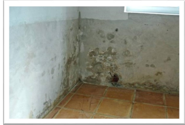
EX 5.6. Fugtskjolder/saltudblomstringer på renoveret kældervæg. På trods af afspærring for opstigende grundfugt og udvendig efterisolering vil saltene i murværket medføre, at der er fugt i kældervæggen. Saltene kan ikke fjernes. (Foto: Erik Brandt)
