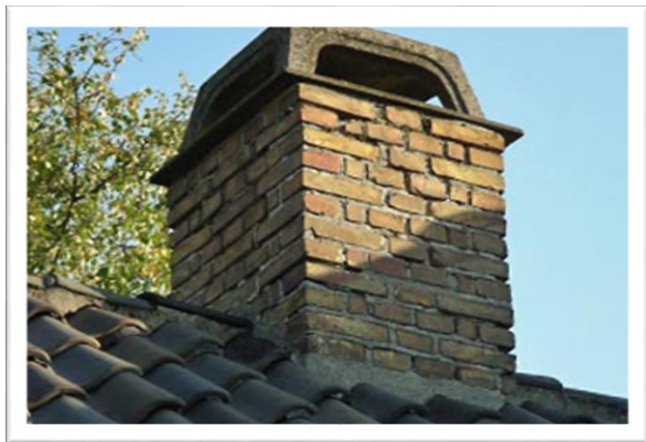
Ex 1.18. Nedbrudte fuger. (Foto: Aktuel Bygge Rådgivning)
