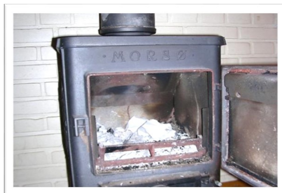
EX 1.26. Revnede og smådefekte udmuringssten. Hvis stenene falder ned, vil ovnsiderne blive rødglødende. (Foto: Aktuel Bygge Rådgivning)
