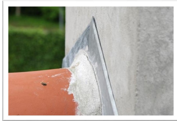
EX 1.23. Inddækning af skorsten uden på pudsens – uden indrilning – det medførte vandindtrængning. (Foto: Erik Brandt)
