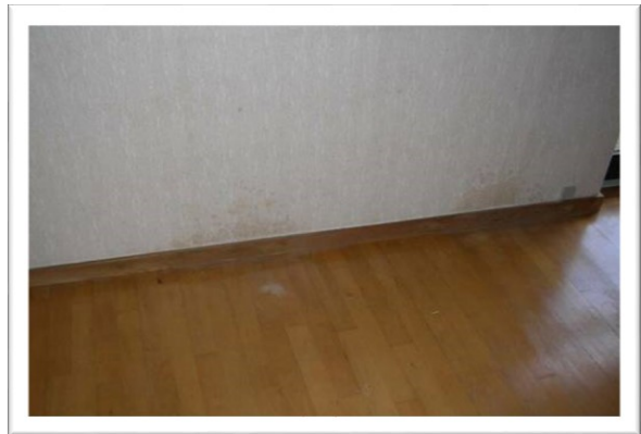
EX 6.13. Eksempel på fugtbeskadiget væg på bagsiden af væg i brusenichen. (Foto: Aktuel Bygge Rådgivning)
