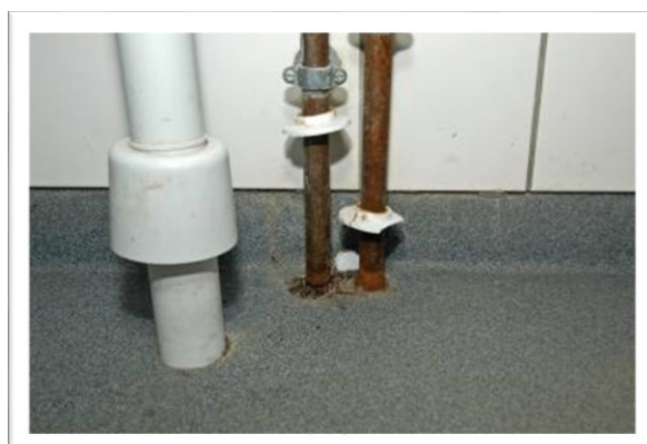
EX 6.8. Rørgennemføringer er ikke udført vandtætte, der mangler vådrumsbøsninger. (Foto: Erik Brandt)
