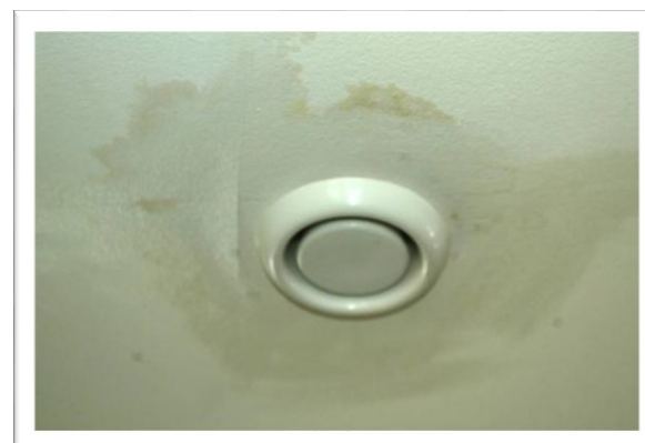
EX 9.4. Skjold på loft – her pga. kondens på uisoleret ventilationskanal. (Foto: Erik Brandt)
