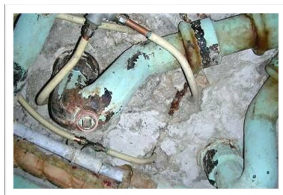
EX 11.13. Kælderdæk med tæringsskader som følge af utilstrækkelig tætning mellem afløbsskålen og gulvkonstruktionen. (Foto: Aktuel Bygge Rådgivning)
