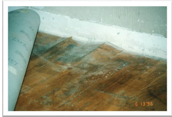
EX 5.12. Trægulv på terrændæk uden kapillarbrydende lag. Gulvet er skadet, fordi der er lagt en diffusionstæt pvc-belægning på trægulvet, hvorved fugten fra underlaget ikke længere kan slippe ud gennem gulvet. (Foto: Erik Brandt).
