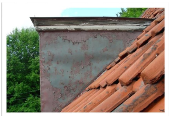
EX 1.17. Inddækninger og tag på kviste skal vedligeholdes. (Foto: Aktuel Bygge Rådgivning)
