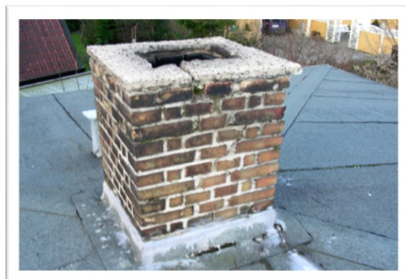
EX 1.21. Revnet skorstensafdækning. (Foto: Aktuel Bygge Rådgivning)
