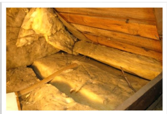
EX 1.9. Dårligt udlagt isolering, som tillige har blokeret ventilationen. (Foto: Erik Brandt)
