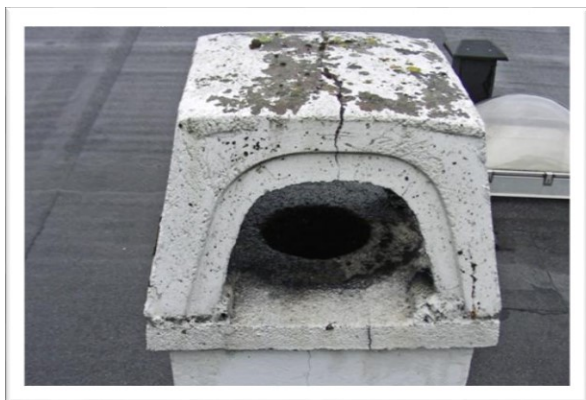
EX 1.20. Revnet skorstensafdækning. (Foto: Aktuel Bygge Rådgivning)
