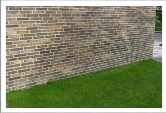
EX 4.4. Fugtopsugning og frostafskalninger ved sokler af murværk. (Foto: Erik Brandt)
