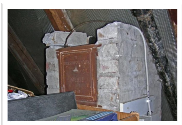
EX 1.27. Skorstenspipe er fjernet, men resten af skorstenen står tilbage. Der kan trænge fugt op gennem skorstenen, fx fra fugtig kælder. (Foto: Aktuel Bygge Rådgivning)
