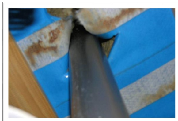
EX 9.2. Utæthed omkring gennemføring i dampspærre medfører risiko for opfugtning af tagkonstruktionen pga. konvektion af fugtig rumluft. (Foto: Erik Brandt)
