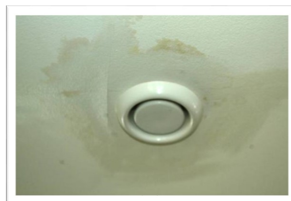
EX 9.4. Skjold på loft – her pga. kondens på uisoleret ventilationskanal. (Foto: Erik Brandt)
