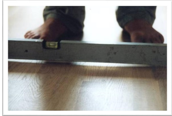
EX 7.2. Trægulv udført med varmefordelingsplader på bærebædder, som er for slappe til, at stivhedskravene kan overholdes. (Foto: Erik Brandt)
