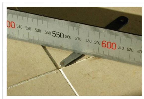
EX 7.5. Spring mellem fliser – omfanget af store spring skal være begrænset, og de må ikke være over 1 mm, (Foto: Erik Brandt)
