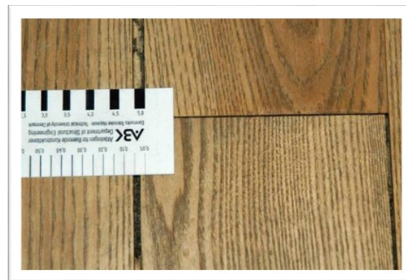
EX 7.8. Store og uensartede fuger i trægulv - sammenlign med fugen mellem brædderne i højre side af billedet. (Foto: Erik Brandt)
