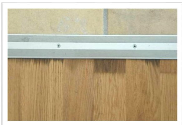
EX 7.9. Misfarvning af egetræsbrædder pga. manglende tæthed af dampspærre ved bræddeender (tætning bag fodpanel) eller pga. meget vand ved vask af gulv. (Foto: Erik Brandt)
