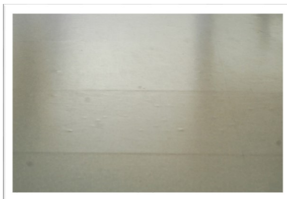
EX 7.10. Pladesamlinger i og urenheder på undergulvet under en linoleumsbelægning ses tydeligt, især i modlys. (Foto: Erik Brandt)
