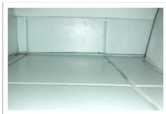
EX 6.11. Sætninger i gulvpladen, fuger slipper. (Foto: Aktuel Bygge Rådgivning)
