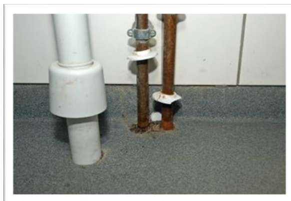
EX 6.8. Rørgennemføringer er ikke udført vandtætte, der mangler vådrumsbøsninger. (Foto: Erik Brandt)
