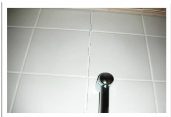
EX 6.10. Flisefuger er revnede, her som følge af stabilitetssvigt i vægkonstruktion. (Foto: Aktuel Bygge Rådgivning)
