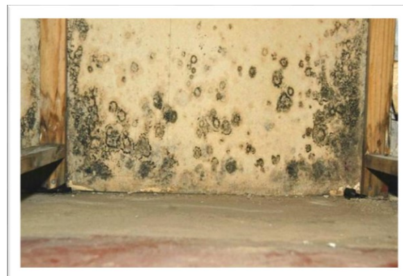
EX 5.4. Skimmelvækst på tapetseret kælderydervæg pga. opfugtning, forårsaget af defekt dræn. (Foto: Erik Brandt)
