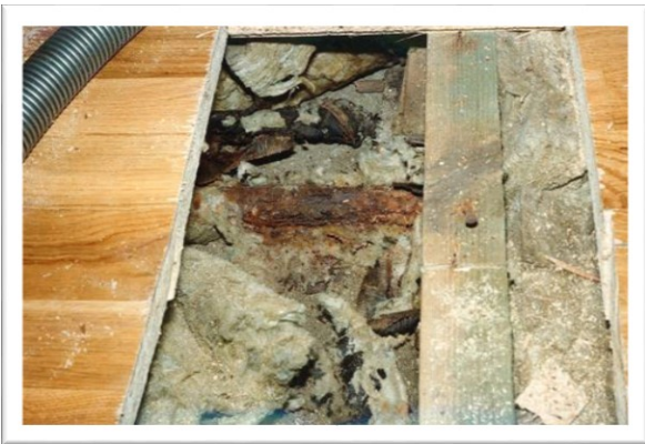
EX 5.13. I ældre gulve uden kapillarbrydende lag kan uisolerede varmerør få fugt fra underlaget til at fordampe, så trægulvet ovenpå skades. Viser sig typisk som mørke striber på gulvet eller opkvældning af spånpladegulve. (Foto: Erik Brandt)
