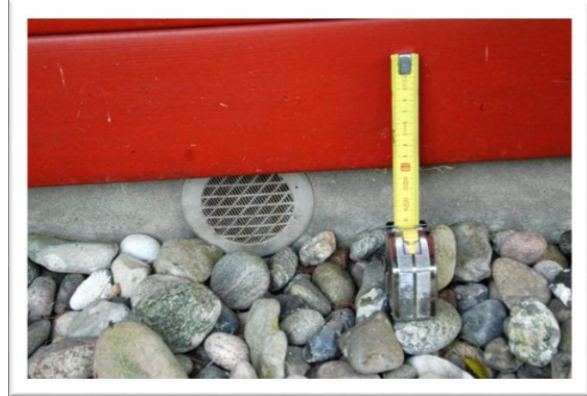
EX 5.8. Ventilationsrist anbragt med underkant ved terræn (i strid med reglen om, at underkant skal være mindst 100 mm over terræn), hvilket betyder, at smeltevand fra sne og i uheldige tilfælde regnvand kan trænge ind i kryberummet. Sokkelhøjden er kun 10 cm, hvilket er for lidt ved træbeklædning. (Foto: Erik Brandt)
