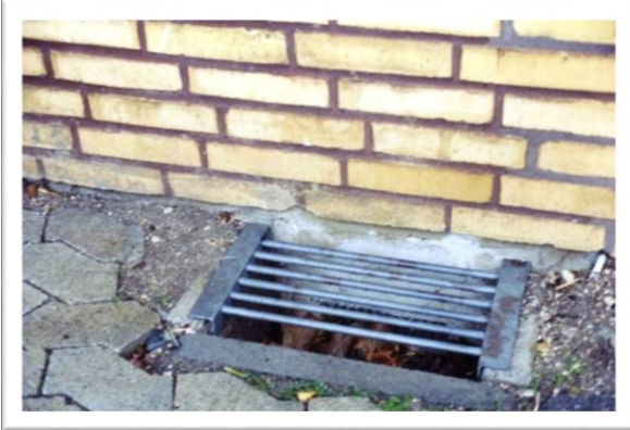
EX 5.7. Ventilationsrist anbragt under terræn. Placeringen hindrer fri gennemstrømning af ventilationsluft, og antallet af ventilationsåbninger skal derfor forøges med 50 %. Hvis der er fald mod en sådan rist, vil vand kunne trænge ind i krybekælderen, og hverken sne eller regn på facaden kan holdes væk fra krybekælderen. (Foto: Erik Brandt)
