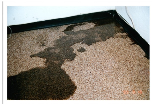
EX 5.2. Vandindtrængning i ældre kælder under regnvejr. Kældre må altid forventes at være tætte mod vand fra almindelig nedbør – ellers skal ejeren oplyse det. (Foto: Erik Brandt)
