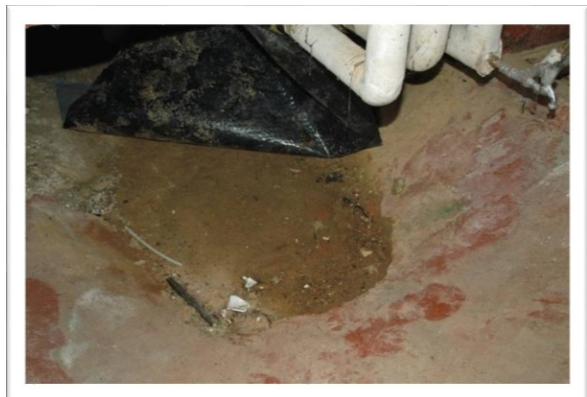
EX 5.10. Krybekælder med fugtig jord i bunden. Der kan afgives store fugtmængder fra jorden, som kan medvirke til at gøre krybekælderen fugtig. (Foto: Erik Brandt)
