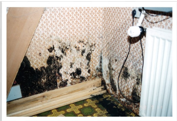
EX 5.1. Skimmelvækst på kældervæg pga. opstigende/indsivende grundfugt. Tætte overflader på vægge bør undgås, da de kan resultere i, at fugten trænger højere op. (Foto: Erik Brandt)
