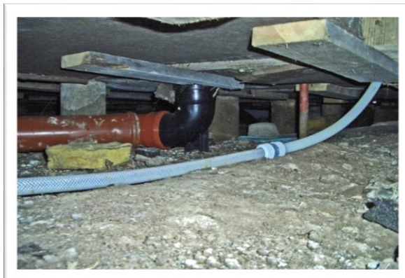
EX 5.9. Krybekælder med jord i bunden uden afdækning. Der er trukket uisolerede rør i krybekælderen med deraf følgende risiko for frostproblemer. (Foto: Erik Brandt)
