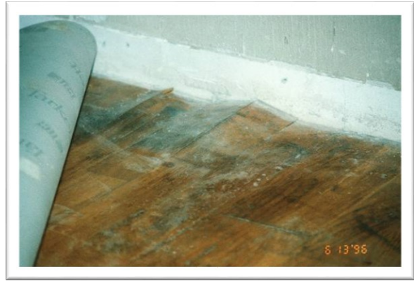
EX 5.12. Trægulv på terrændæk uden kapillarbrydende lag. Gulvet er skadet, fordi der er lagt en diffusionstæt pvc-belægning på trægulvet, hvorved fugten fra underlaget ikke længere kan slippe ud gennem gulvet. (Foto: Erik Brandt).
