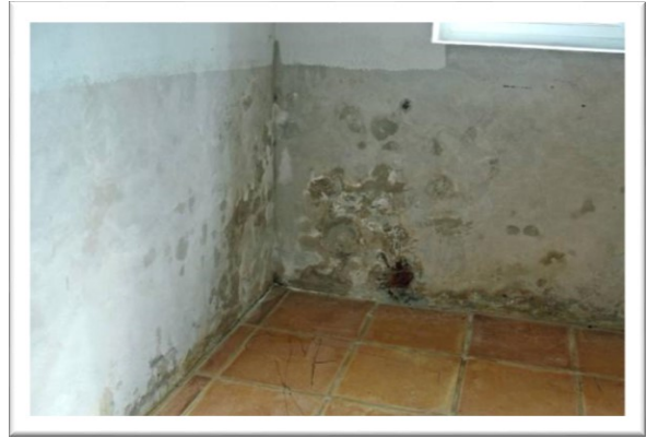
EX 5.6. Fugtskjolder/saltudblomstringer på renoveret kældervæg. På trods af afspærring for opstigende grundfugt og udvendig efterisolering vil saltene i murværket medføre, at der er fugt i kældervæggen. Saltene kan ikke fjernes. (Foto: Erik Brandt)
