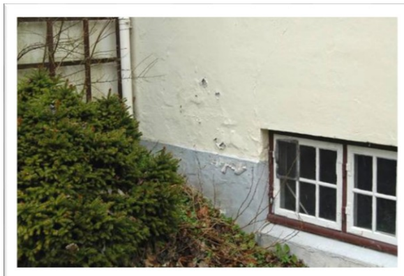
EX 4.8. Opfyldning af jord langs huset til over fugtspærre – her ved etablering af terrasse – kan betyde, at fugt trækker op i murværket. (Foto: Erik Brandt)
