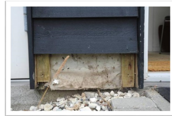
EX 4.7. For lille sokkelhøjde kan give alvorlige skader, især på træværk. (Foto: Erik Brandt)
