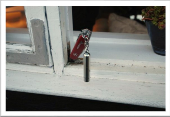
EX 3.5. Nedbrudt træ i samling i gammelt vindue uden fald på bundfals. (Foto: Erik Brandt)
