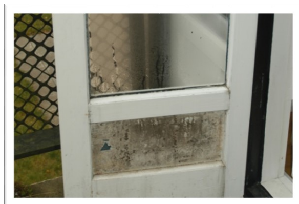
EX 3.4. Kondens på glas i yderste ramme ved dør med forsatsramme. (Foto: Erik Brandt)
