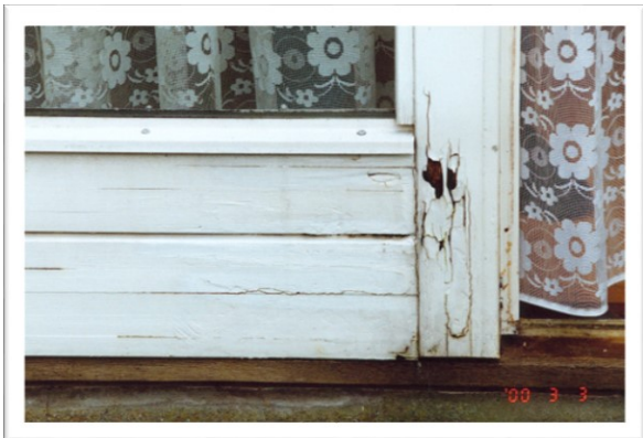
EX 3.1. I en periode omkring 1970-2000 var laminerede konstruktioner almindelige, både til døre og vinduer. Der er stor risiko for opfugtning/nedbrydning via limfugerne. (Foto: Erik Brandt)
