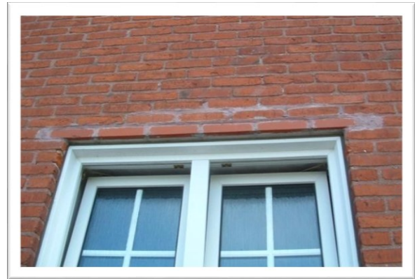
EX 2.4. Indbygget ståltegl med for lille vederlag på \frac{1}{4} sten. (Foto: Niels Christoffersen)
