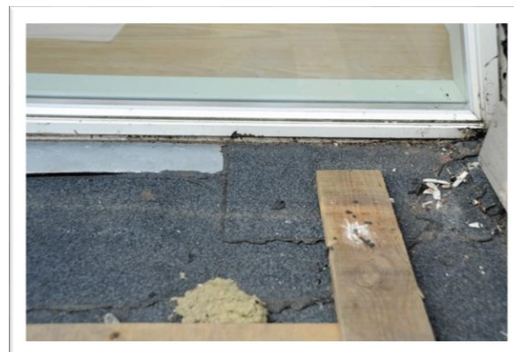
EX 2.12. Tagterrasse med lav inddækningshøjde mod vindue med stor risiko for fugtskader til følge. (Foto: Erik Brandt)
