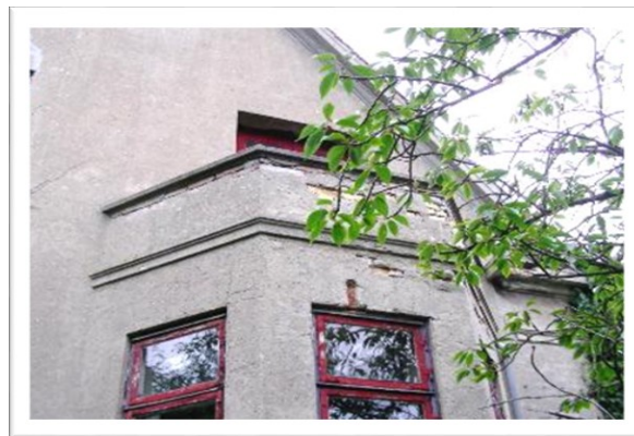
EX 2.10. Tagterrasse med frostskeer på værn. (Foto: Aktuel Bygge Rådgivning)
