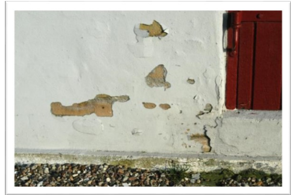
EX 2.2. Afskalning af facadepuds og maling som følge af opstigende grundfugt. (Foto: Erik Brandt)
