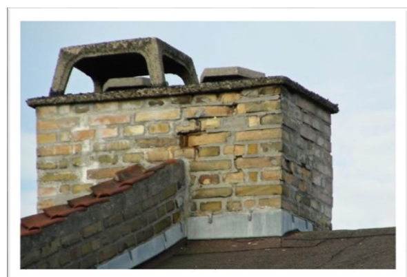
Ex 1.19. Revne i skorsten. (Foto: Aktuel Bygge Rådgivning)
