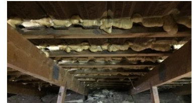
PUR-skum, hvor der er fugtskader, selv om skum ikke berører træet.
