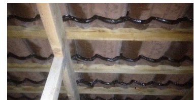
Bitumenfuge, som ikke viser utæthed, selv om der ikke er fuget 5 cm op ad de lodrette fuger. Sten har naturlig fugt efter regn.
