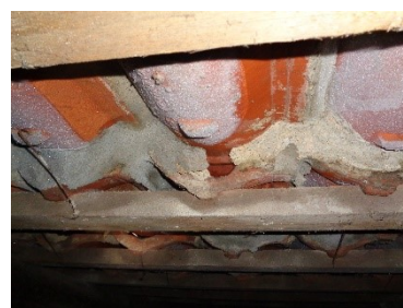
Understrygning er ikke intakt.
