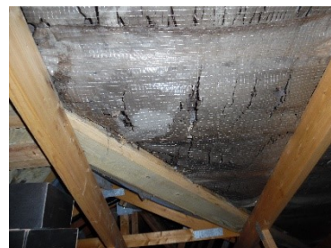
Ødelagt undertag af banevarer.
