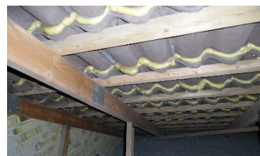
Understrygning af polyuretan er intakt.
