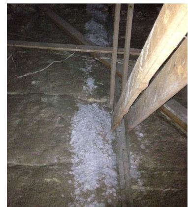
Indtørret asbestslam i fast form. Rester efter afvaskning af eternittag.
