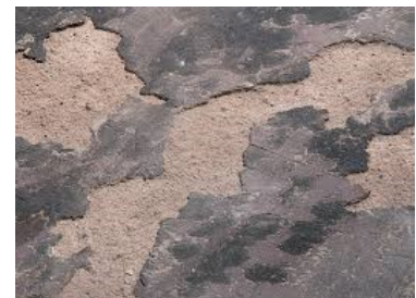
Magnesitgulve eller tilsvarende asbestholdige gulve. Belægning, som ikke er intakt.
