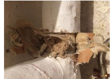
Ødelagt rørisolering med asbestholdigt materiale.
