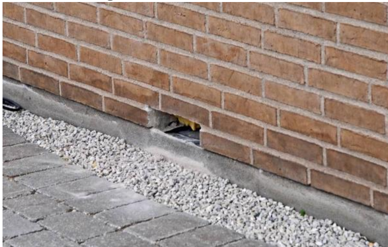
EX 4.3 Opfugtning af murværk fordi murpappen ikke er ført frem til forkant af sokkel. (Foto: Erik Brandt)
