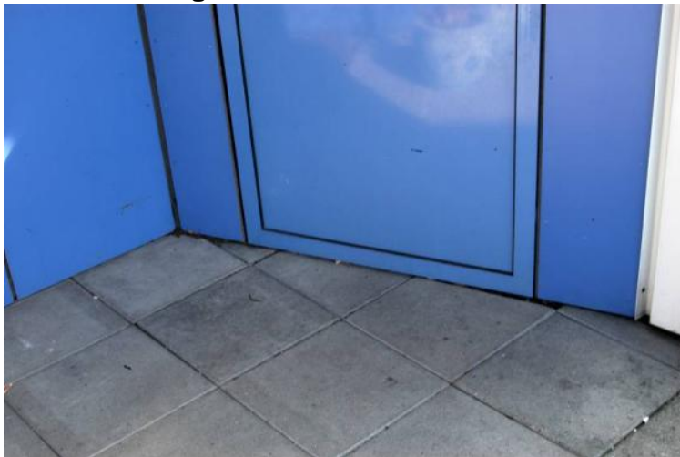
EX 4.6 Ingen niveauforskel mellem dør og terrasse gør tætning under dør meget vanskelig. (Foto: Erik Brandt)
