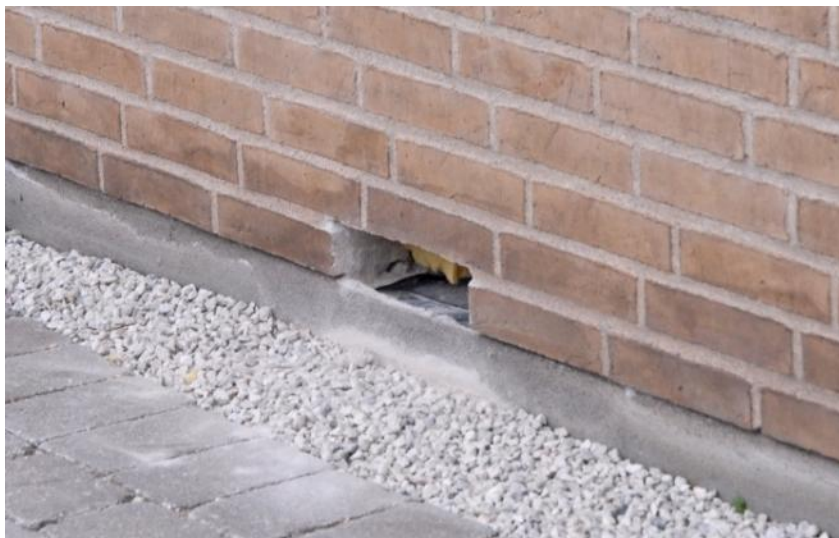
EX 2.1. Opfugtning af facaden fordi murpappen ikke er ført frem til forkanten af facaden. Der må ikke pudses hen over murpappen, fordi pudsen virker som en væge, der kan trække fugt op. (Foto: Erik Brandt)
