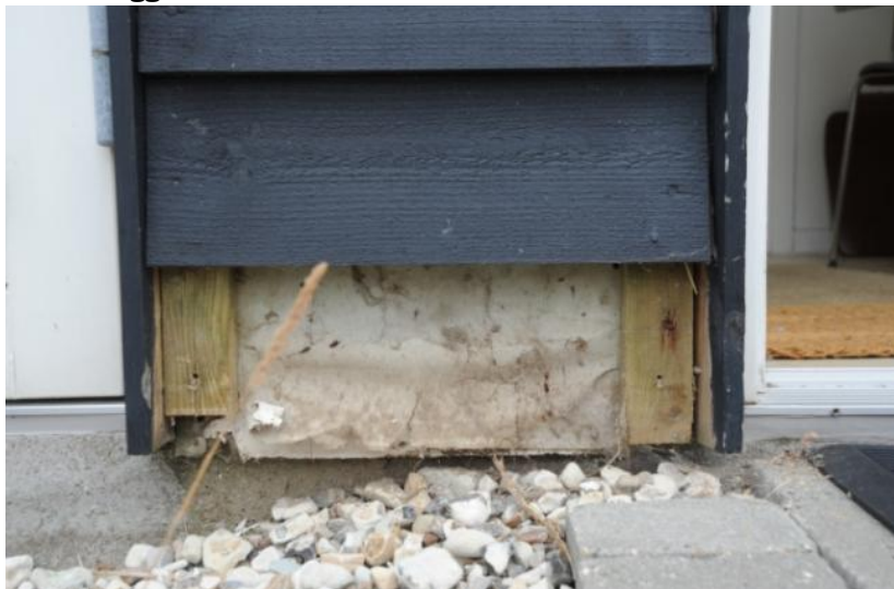
EX 2.5. Nedbrydning af let facade fordi vindtæt afdækning (gipsplade) og beklædning er afsluttet for tæt på terræn. (Foto: Erik Brandt)
