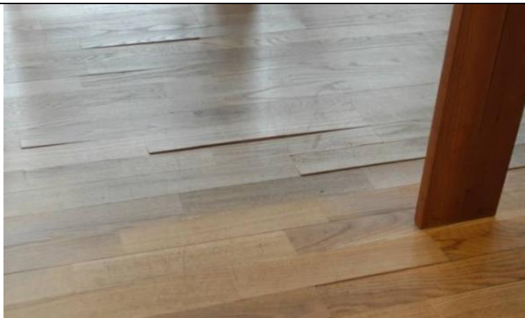
EX 7.1. Delaminering af lamelbrædder. (Foto: Erik Brandt)
