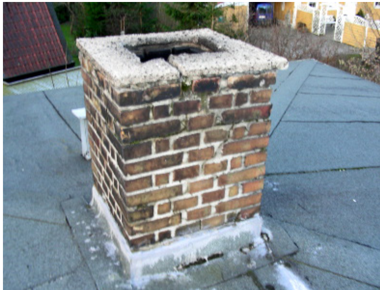
EX 1.21. Revnet skorstensafdækning. (Foto: Aktuel Bygge Rådgivning)
