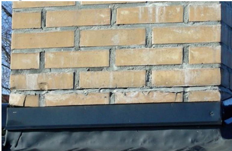
EX 1.22. Fuge udført med fugemassefuge – stenen på hjørnet er knækket. (Foto: Aktuel Bygge Rådgivning)
