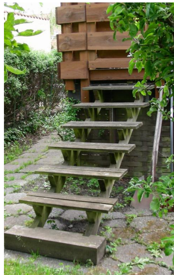
EX 10.2. Eneste udgang fra havedøren til haven; højde mere end 60 cm og intet værn. (Foto: Aktuel ByggeRådgivning)
