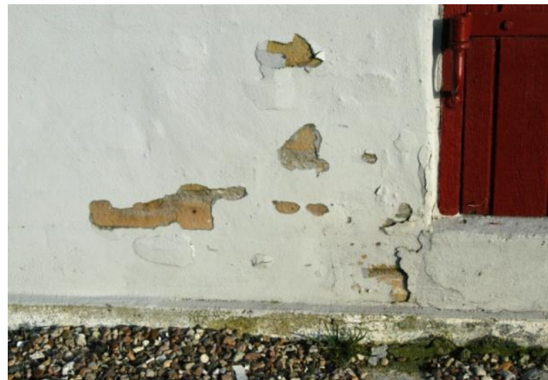
EX 2.2. Afskalning af facdepuds og maling som følge af opstigende grundfugt. (Foto: Erik Brandt)
