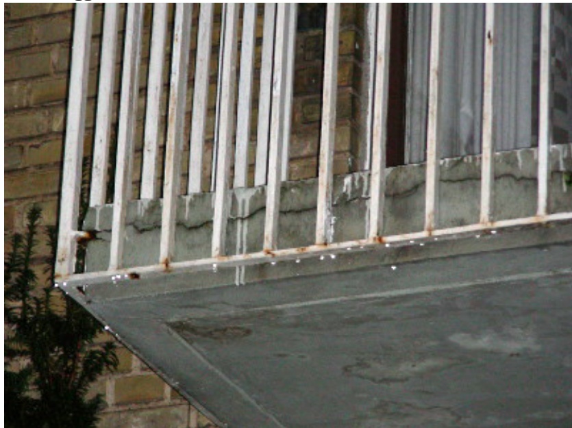
EX 2.11. Udliggerjernaltan med tegn på gennemsvivning og skader i beton (Foto: Aktuel ByggeRådgivning)
