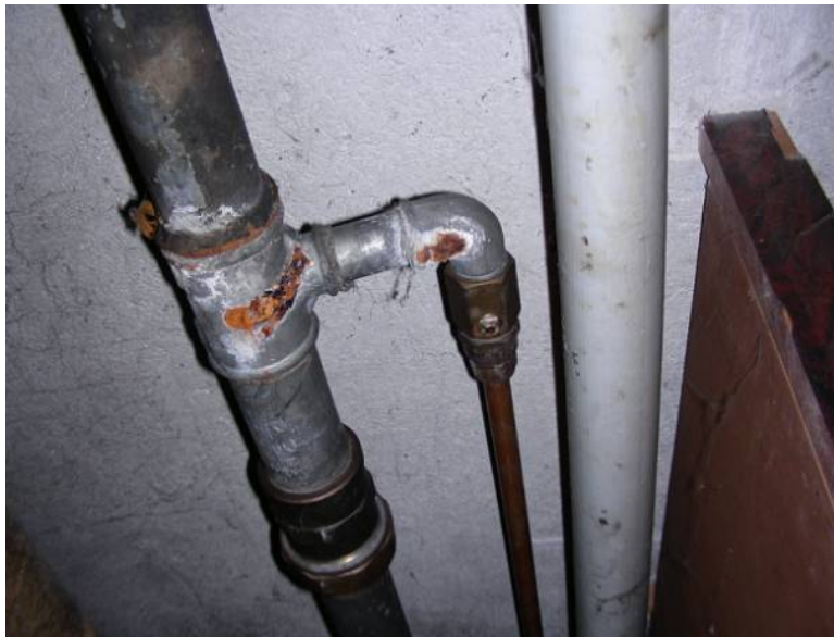
EX 11. 9 Brugsvandsanlæg der for nylig er repareret. Der er anvendt kobberholdige komponenter, sammen med galvaniserede stålrør. (Foto: AktuelByggerådgivning)
