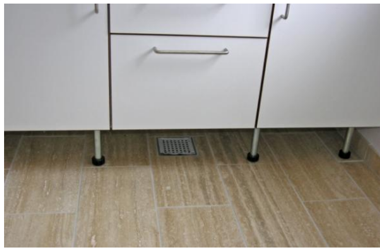
EX 11.4. Gulv afløb monteret svært tilgængeligt under en skuffe/skab. (Foto: Erik Brandt)
