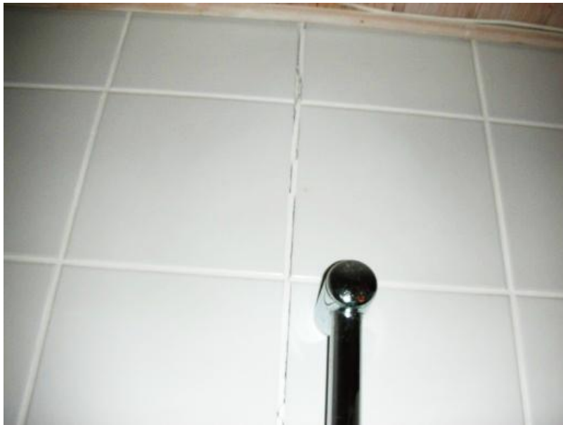
EX 6.10. Flisefuger revnet, her som følge af stabilitets svigt i vægkonstruktion. (Foto: Aktuel Bygge Rådgivning)
