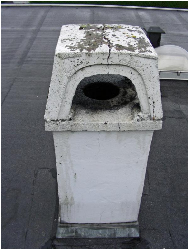
EX 1.20. Revnet skorstensafdækning. (Foto: Aktuel Bygge Rådgivning)
