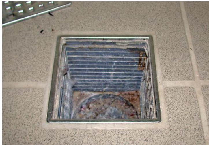
EX 11.15. Gammelt gulvafløb med mange forhøjelsesringe som er monteret i forbindelse med "modernisering" af badeværelse. Forhøjelse af afløb er ikke i overensstemmelse med afløbsnormen, og hver ekstra ring/ramme forøger risikoen for vandgennemtrængning. Et enkelt fabrikat (Purus) har VA-godkendelse til at forhøje deres eget afløb med få rammer. (Foto: Erik Brandt)
