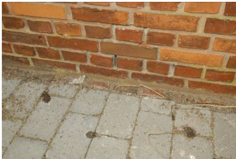
EX 4.5. Opfugtning af murværk (og gulv) fordi terrænet foran huset er hævet op over fugtspærren. (Foto: Erik Brandt)
