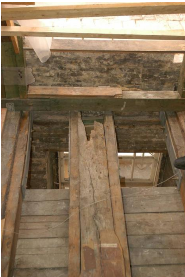
EX 9.1. Bortrådet bjælkeende i træbjækelag pga. utæthed ved tagfod. (Foto: Erik Brandt)
