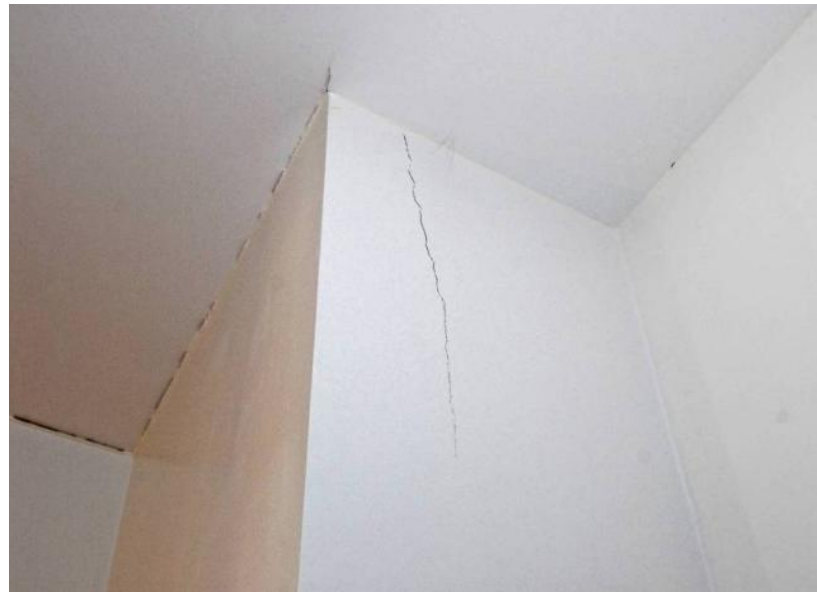
EX 8.4. Revner i letbetonindervæg pga. svind og påvirkning fra tagkonstruktion (bemærk revnen langs loftet). (Foto: Erik Brandt)
