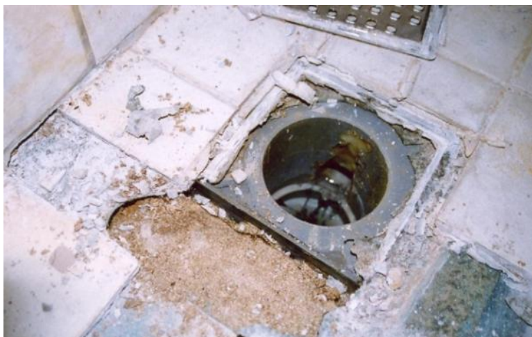
EX 11.1. Nedbrudt gulv pga. gulv afløb som ikke er korrekt monteret. (Foto: Erik Brandt)
