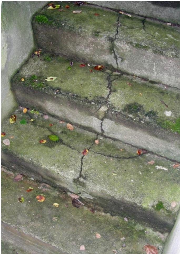
EX 10.3. Revner i trin på kældertappe – risiko for nedbrydning som følge af frost. (Foto: Aktuel ByggeRådgivning)
