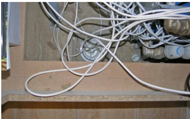
EX 11.3. Gulv afløb placeret svært tilgængeligt i bunden af et skab. (Foto: Erik Brandt)
