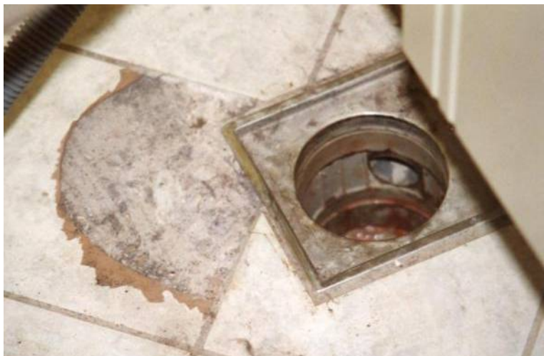
EX 11.14. Gulvafløb forhøjet med tilfældig metalring. Der er lavet sideindløb i forhøjelsen. Utæthed af afløbet resulterede i store skader på etageadskillelsen. (Foto: Erik Brandt)
