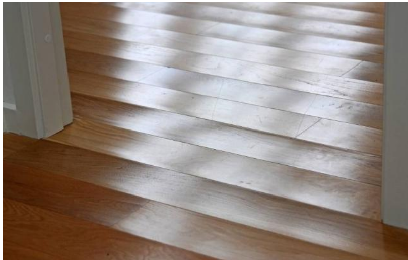
EX 5.11. "Vaskebræt" af trægulv som skyldes fugtpåvirkning nedefra. Det kan skyldes manglende fugtspærre eller kondens på fugtspærre, fx pga. for meget isolering over fugtspærren. (Foto: Erik Brandt)
