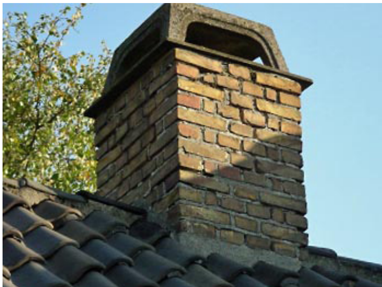
Ex 1.18. Nedbrudte fuger. (Foto: Aktuel Bygge Rådgivning)
