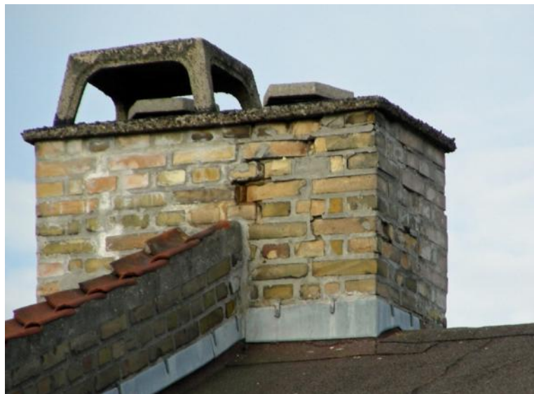
EX 1.19. Revne i skorstensvange. (Foto: Aktuel Bygge Rådgivning)
