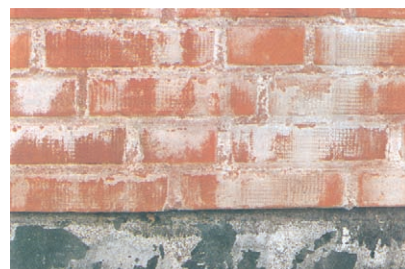
Saltudblomstring (calciumcarbonat) på murværk (foto: BYG-ERFA)
