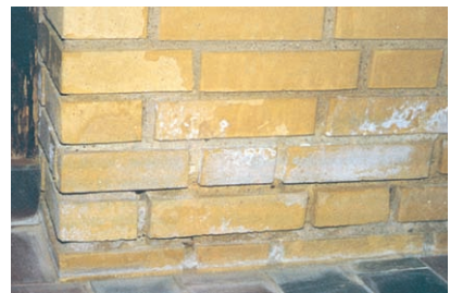
Nederste fuger nedbrudt pga. fysisk slid fx rengøring (foto: BYG-ERFA)
