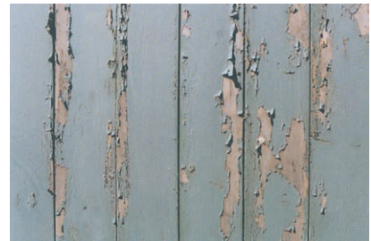
Afskallet maling pga. litapone-holdig maling (foto: BYG-ERFA)
