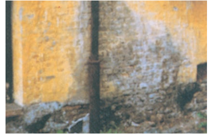
Utæt nedløbsrør (foto: BYG-ERFA)
