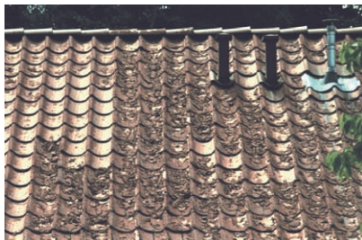
Afskalninger (foto: Byggeskadefonden)
