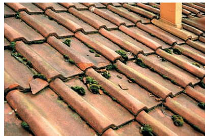
Afskalninger (foto: Byggeskadefonden)
