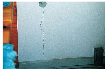
Revnet limfuge ved letbetonelementer (foto: Byggeskadefonden)
