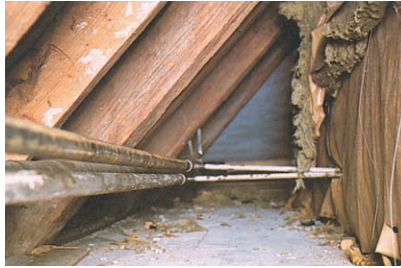
Uisolerede varmerør i skunk (foto: BYG-ERFA)
