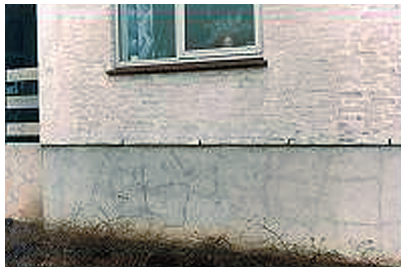
Revner langs blokstenenes fuger (foto: Byggeskadefonden)
