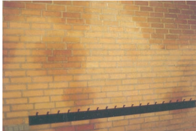
Fugt i formure og skalmure (foto: BYG-ERFA)
