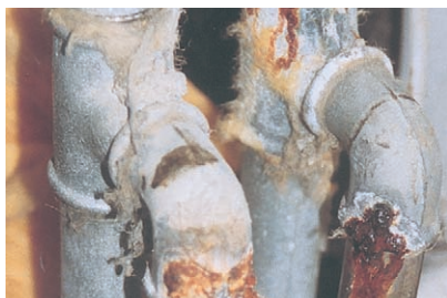
Kobbertæring og galvanisk tæring (foto: BYG-ERFA)
