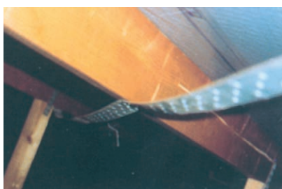
Slappe hulbånd – manglende stabilitet (foto: BYG-ERFA).
