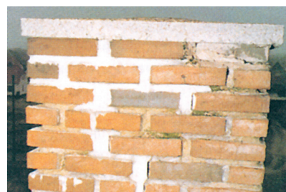
Frostsprængt murværk i skorsten (foto: BYG-ERFA).
