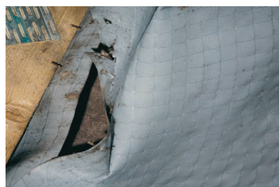
Byggesjusk (foto: Byggeskadefonden)
