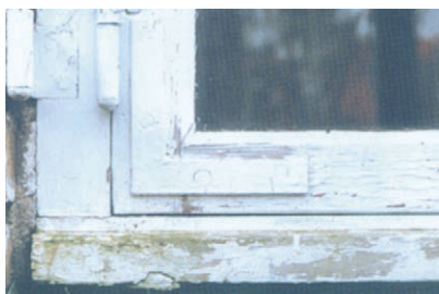
Skader i de nederste 20–25 cm af vindue (foto: BYG-ERFA)
