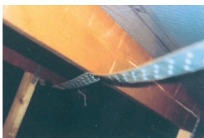
Slappe hulbånd – manglende stabilitet (foto: BYG-ERFA).
