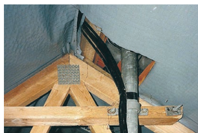
Forkert udført rørgennemføring (foto: BYG-ERFA).
