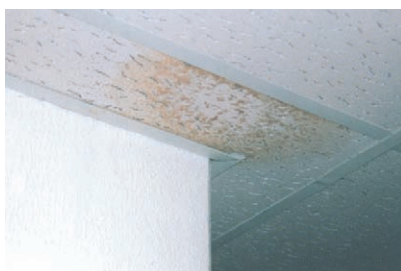
Fugtplet på nedhængt loft (foto: BYG-ERFA)
