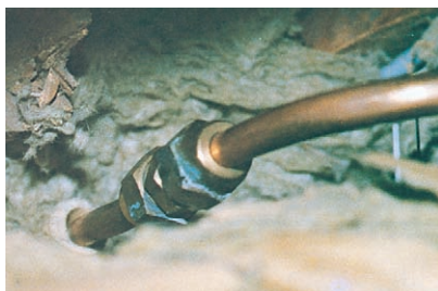
Mekanisk samling placeret i skunkrum med isoleringsmateriale (foto: BYG-ERFA)
