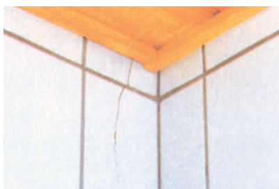
Revnet væg og fliser i badeværelse (foto: BYG-ERFA)
