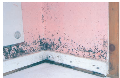
Skimmelangreb på pudset og malet indv. væg (foto: BYG-ERFA)
