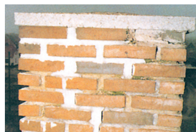
Frostsprængt murværk i skorsten (foto: BYG-ERFA).
