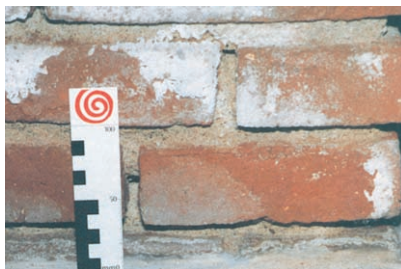
Nedbrudte fuger pga. saltudfældning (foto: BYG-ERFA)
