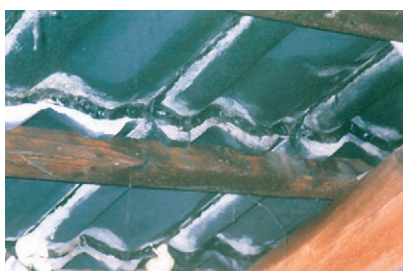
Fugt på undersiden af tagbelægning (foto: BYG-ERFA).
