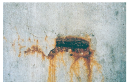
Afskalning pga. "rusten" armering i beton-element (foto: BYG-ERFA)
