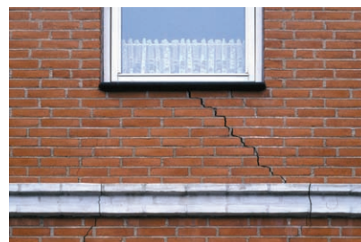
Revner i ydervæg af murværk (foto: Byggeskadefonden)
