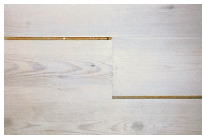
Åbne fuger i trægulv (foto: BYG-ERFA)
