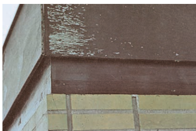
Eksempel på krydsfiner anvendt til stern. Yderfinerens fibre er fejlagtigt anbragt vandret, og den lodrette kant er ubeskyttet (foto: BYG-ERFA)
