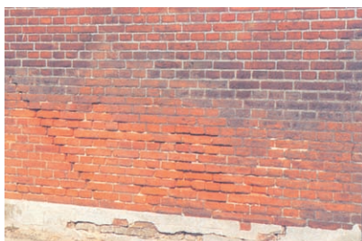
Forvitret murværk (foto: BYG-ERFA)
