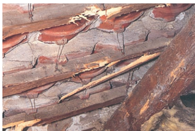
Husbukke i tagkonstruktion (foto: BYG-ERFA).
