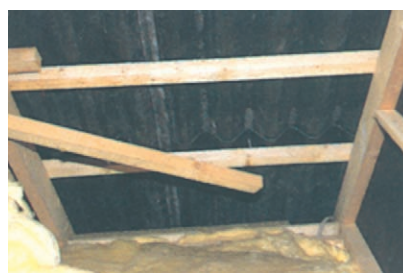
Fejlplaceret skrålægte – manglende stabilitet (foto: BYG-ERFA).
