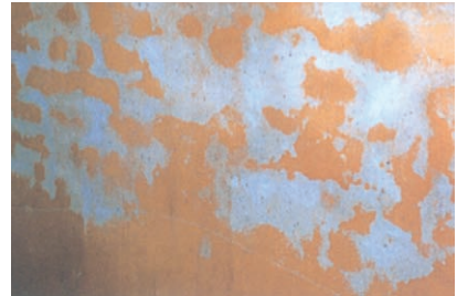
Nedbrudt kalk og puds på fugtbelastet facade (foto: BYG-ERFA)
