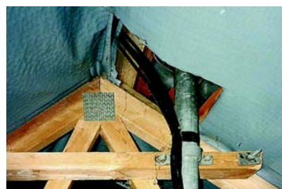
Forkert udført rørgennemføring (foto: BYG-ERFA).
