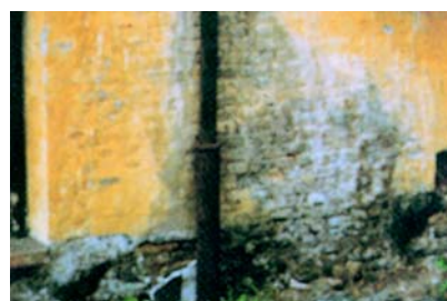
Utæt nedløbsrør (foto: BYG-ERFA)
