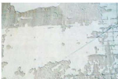
Afskalning af pudset facade behandlet med diffusionstæt maling (foto: BYG-ERFA)
