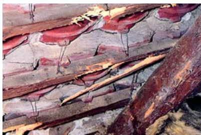
Husbukke i tagkonstruktion (foto: BYG-ERFA).
