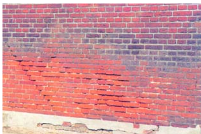
Forvitret murværk (foto: BYG-ERFA)
