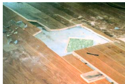
Bulet trægulv (foto: BYG-ERFA)
