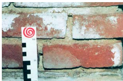
Nedbrudte fuger pga. saltudfældning (foto: BYG-ERFA)
