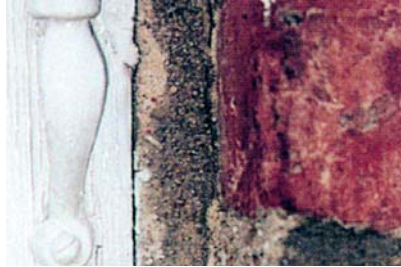
Fugeslip i mørtelfuge (foto: BYG-ERFA)
