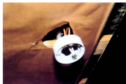
Dampspærre der ikke slutter tæt til væg, og som desuden er gennemhullet (foto: BYG-ERFA)
