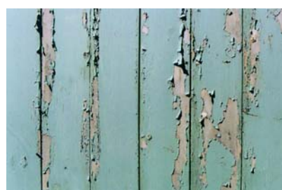
Afskallet maling pga. litapone-holdig maling (foto: BYG-ERFA)
