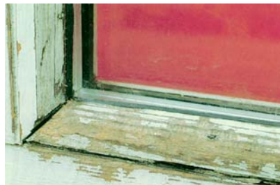
Træoverfladen nedbrudt pga. gråmuld (foto: BYG-ERFA)
