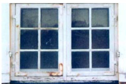
Rustgennemslag på beslag (foto: BYG-ERFA)
