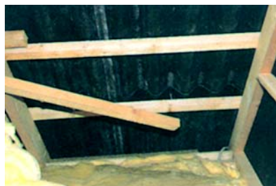
Fejlplaceret skrålægte – manglende stabilitet (foto: BYG-ERFA).
