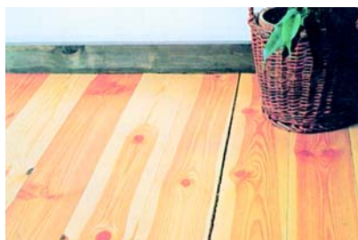
Revner i fyrretrægulv efter udtørring af for fugtigt monterede gulvbrædder (foto: BYG-ERFA)
