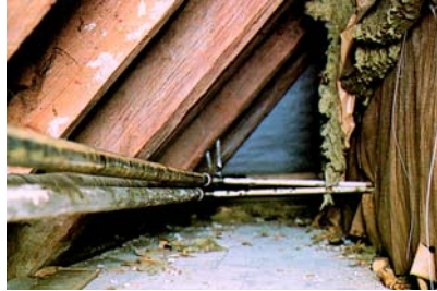
Uisolerede varmerør i skunk (foto: BYG-ERFA)
