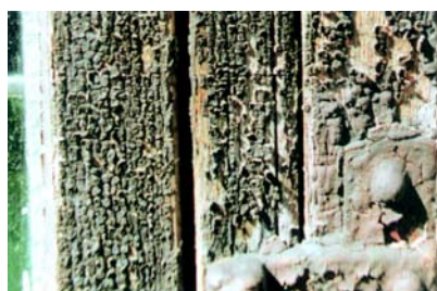
Krakeleringer/afskalinger (foto: BYG-ERFA)
