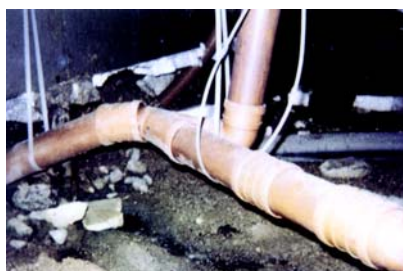
Mangelfuld opstropning under dæk og bjælker (foto: BYG-ERFA)
