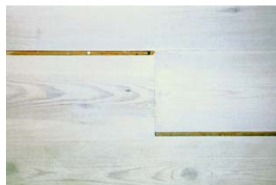
Åbne fuger i trægulv (foto: BYG-ERFA)
