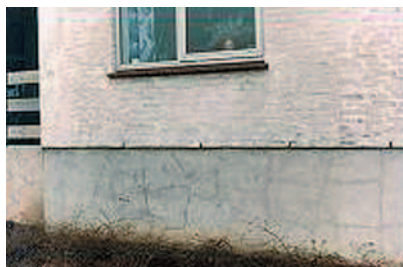
Revner langs blokstenenes fuger (foto: Byggeskadefonden)
