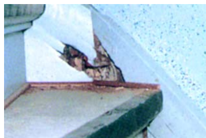
Råd og svamp i trappevange mod ydervæg (foto: BYG-ERFA)
