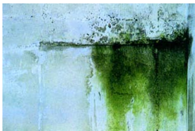
Udludning af beton omkring utæt støbeskel i kældervæg (foto: BYG-ERFA)
