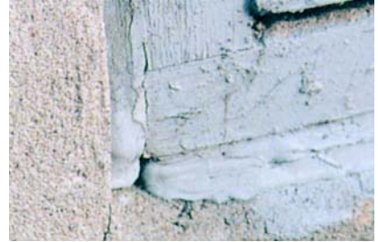
Dårligt udført fugearbejde (foto: BYG-ERFA)
