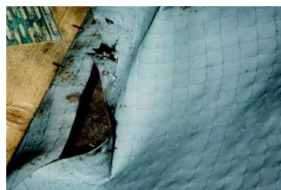
Byggesjusk (foto: Byggeskadebogen)
