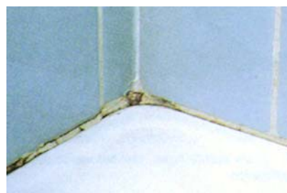
Misfarvet og fugtbelastet fuger (foto: BYG-ERFA)
