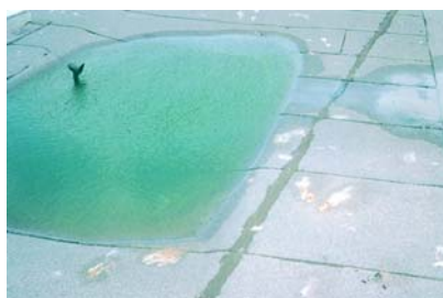
Lunke over svampenedbrudt tagelement (foto: BYG-ERFA).
