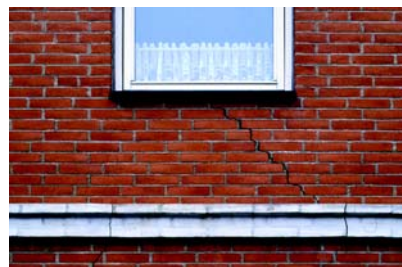
Revner i ydervæg af murværk (foto: Byggeskadefonden)
