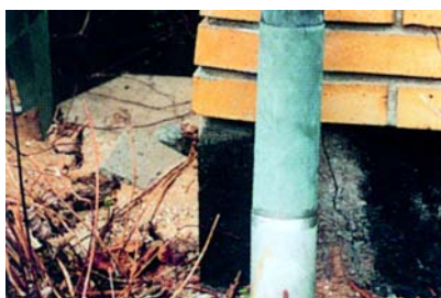
Gulvet i denne bygning blev presset op og fundamentet trykket ud pga. ekspanderende slagge (foto: BYG-ERFA)
