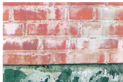
Saltudblomstring (calciumcarbonat) på murværk (foto: BYG-ERFA)
