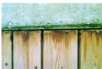
Nedbrydning af træ pga. manglende konstruktiv beskyttelse (foto: BYG-ERFA)
