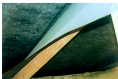
Overskydende undertagsmateriale der skal bortskæres (foto: BYG-ERFA).
