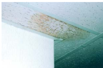
Fugtplet på nedhængt loft (foto: BYG-ERFA)
