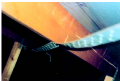
Slappe hulbånd – manglende stabilitet (foto: BYG-ERFA).
