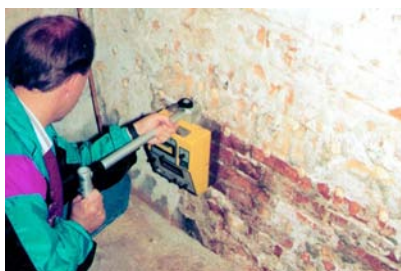
Afskalning af puds og maling (foto: BYG-ERFA)
