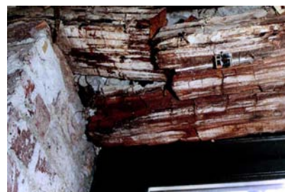
Nedbrudt døroverligger af træ i kældre (foto: BYG-ERFA)
