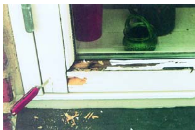
Nedbrudt glasliste (foto: BYG-ERFA)
