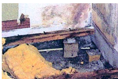
Fugtskade på væg mod badeværelse (foto: BYG-ERFA)
