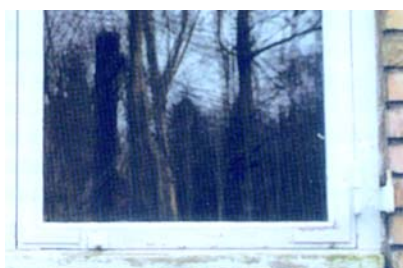
Nedbrudt maling i karmens bundstykke (foto: BYG-ERFA)
