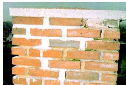
Frostsprængt murværk i skorsten (foto: BYG-ERFA).
