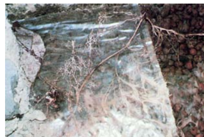
Hussvamp i træfiberplade i terrændæk (foto: BYG-ERFA)
