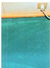
Revner i letbetonelementer (foto: BYG-ERFA)
