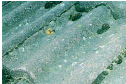
Mosdannelser, der leder vandet ind til utætheder, som ellers ikke ville medføre fugtskader (foto: BYG-ERFA)
