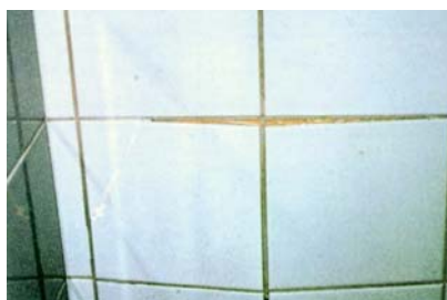
Løstsiddende fliser (foto: BYG-ERFA)
