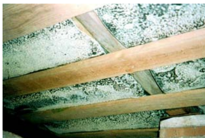
Svamp på undersiden af krybekælderdek (foto: BYG-ERFA)
