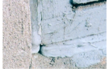
Dårligt udført fugearbejde (foto: BYG-ERFA)
