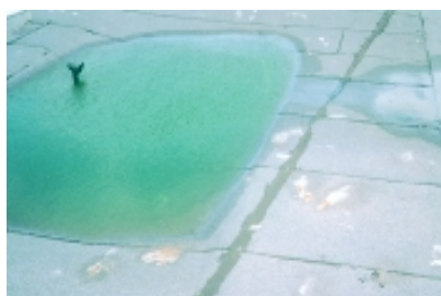
Lunke over svampenedbrudt tagelement (foto: BYG-ERFA).
