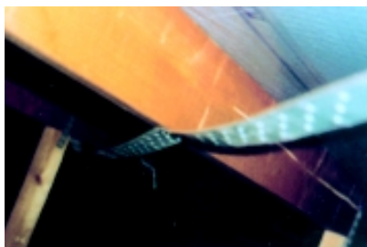
Slappe hulbånd – manglende stabilitet (foto: BYG-ERFA).
