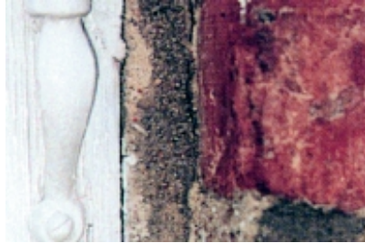
Fugeslip i mørtelfuge (foto: BYG-ERFA)
