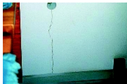
Revnet limfuge ved letbetonelementer (foto: Byggeskadefonden)
