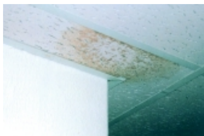
Fugtplet på nedhængt loft (foto: BYG-ERFA)
