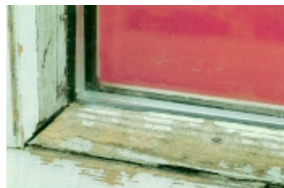
Træoverfladen nedbrudt pga. gråmuld (foto: BYG-ERFA)
