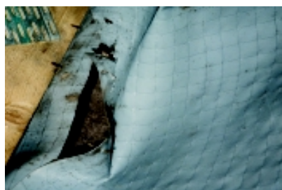
Byggesjusk (foto: ByggeskadeFonden)
