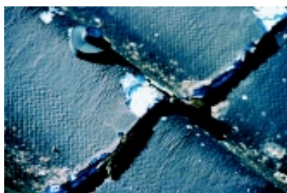
Afskalning (foto: Byggeskadefonden).
