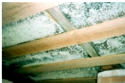
Svamp på undersiden af krybekælderdek (foto: BYG-ERFA)
