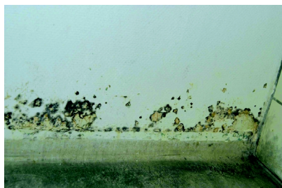
Skimmel på malerbehandlet væg over sokkel uden for bruseniche (foto: BYG-ERFA)
