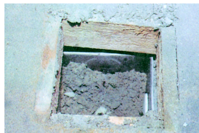
For lavt placeret afløb i terrændæk (foto: BYG-ERFA)
