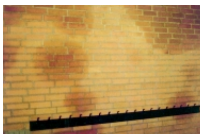
Fugt i formure og skalmure (foto: BYG-ERFA)
