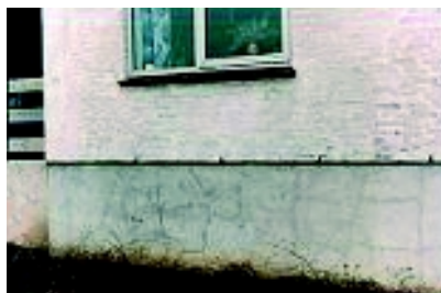
Revner langs blokstenenes fuger (foto: Byggeskadefonden)
