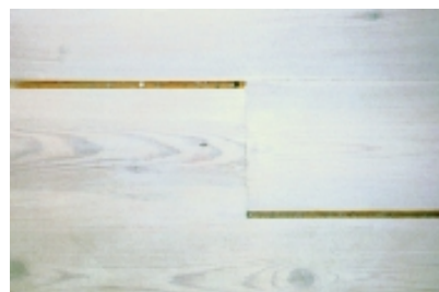
Åbne fuger i trægulv (foto: BYG-ERFA)
