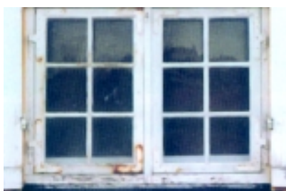
Rustgennemslag på beslag (foto: BYG-ERFA)
