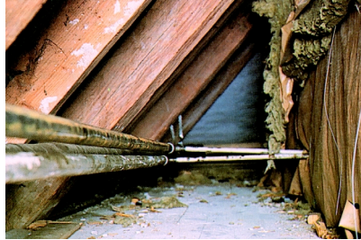
Uisolerede varmerør i skunk (foto: BYG-ERFA)
