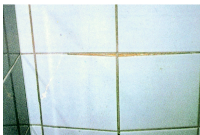
Løstsiddende fliser (foto: BYG-ERFA)
