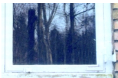
Nedbrudt maling i karmens bundstykke (foto: BYG-ERFA)
