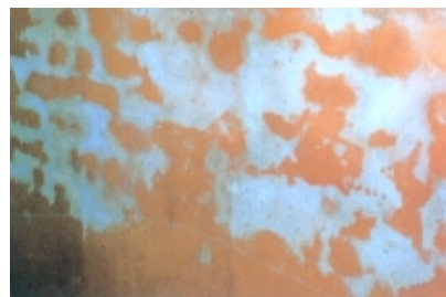
Nedbrudt kalk og puds på fugtbelastet facade (foto: BYG-ERFA)
