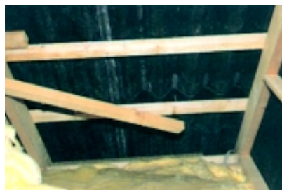
Fejlplaceret skrålægte – manglende stabilitet (foto: BYG-ERFA).
