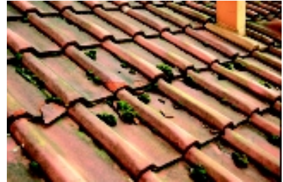
Afskalninger (foto: Byggeskadefonden)
