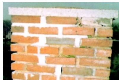
Frostsprængt murværk i skorsten (foto: BYG-ERFA).
