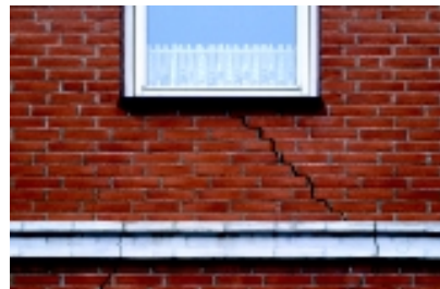
Revner i ydervæg af murværk (foto: Byggeskadefonden)
