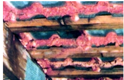
PUR-skum med en blande fejl, der har medført opfugtning af lægter og spær (foto: BYG-ERFA)
