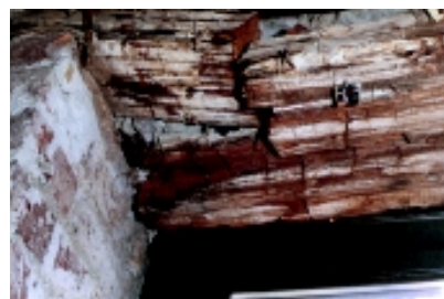
Nedbrudt dørøverligger af træ i kælder (foto: BYG-ERFA)
