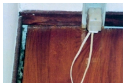
Ydervæg der er presset ud pga. ekspanderende slagge (foto: BYG-ERFA)
