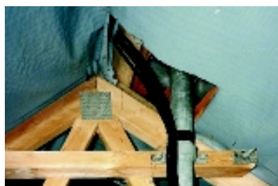
Forkert udført rørgennemføring (foto: BYG-ERFA).
