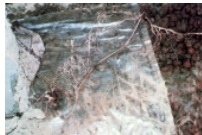
Hussvamp i træfiberplade i terrændæk (foto: BYG-ERFA)
