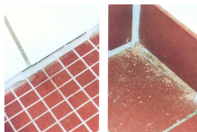
Fugeslip mellem gulv-væg (foto: BYG-ERFA)
