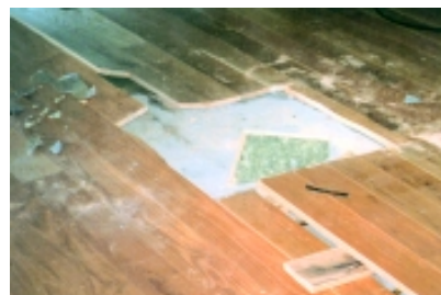
Bulet trægulv (foto: BYG-ERFA)
