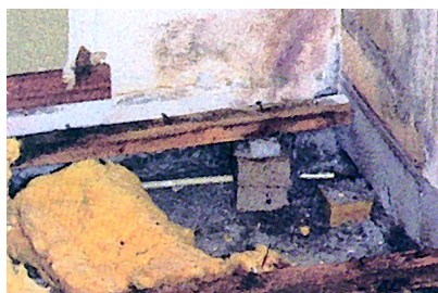
Fugtskade på væg mod badeværelse (foto: BYG-ERFA)
