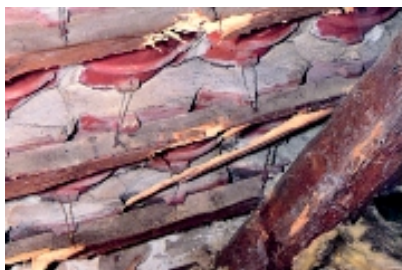
Husbukke i tagkonstruktion (foto: BYG-ERFA).
