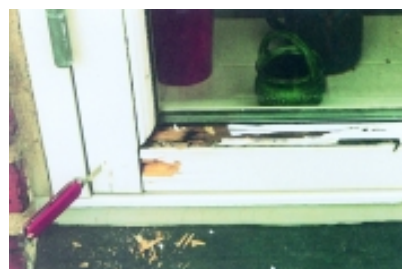
Nedbrudt glasliste (foto: BYG-ERFA)
