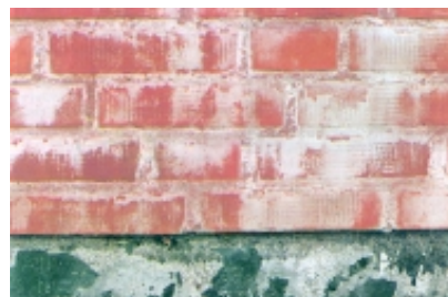
Saltudblomstring (calciumcarbonat) på murværk (foto: BYG-ERFA)
