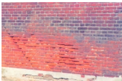
Forvitret murværk (foto: BYG-ERFA)
