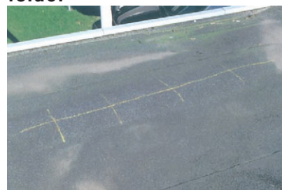
Dampbuler (foto: BYG-ERFA).
