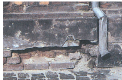
Nedbrudt facade der medføre risiko for svampeangreb (foto: BYG-ERFA)
