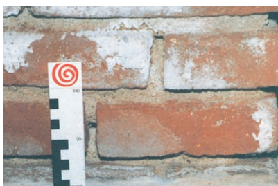
Nedbrudte fuger pga. saltudfældning (foto: BYG-ERFA)
