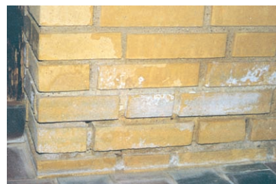
Nederste fuger nedbrudt pga. fysisk slid fx rengøring (foto: BYG-ERFA)
