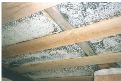
Svamp på undersiden af krybekælderdek (foto: BYG-ERFA)
