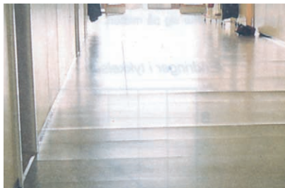
Lunker ved belægninger af linoleum og PVC (foto: BYG-ERFA)
