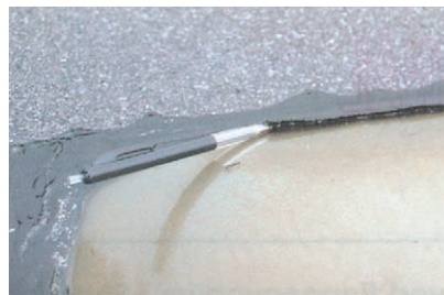
Asfaltfuge mellem pap og kuppel har løsnet sig (foto: BYG-ERFA).
