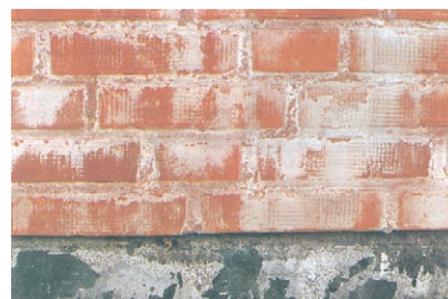
Saltudblomstring (calciumcarbonat) på murværk (foto: BYG-ERFA)
