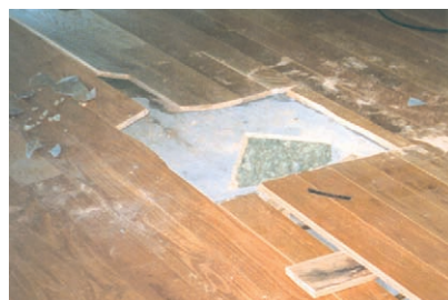
Bulet trægulv (foto: BYG-ERFA)
