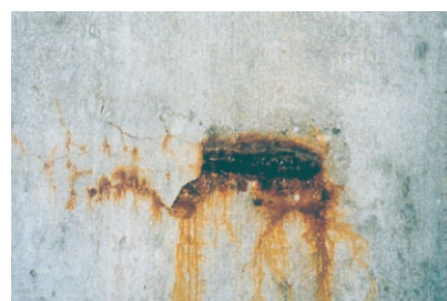
Afskalning pga. "rusten" armering i beton-element (foto: BYG-ERFA)
