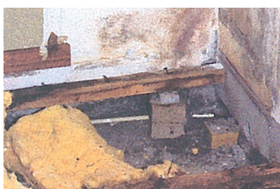
Fugtskade på væg mod badeværelse (foto: BYG-ERFA)
