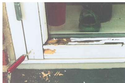
Nedbrudt glasliste (foto: BYG-ERFA)
