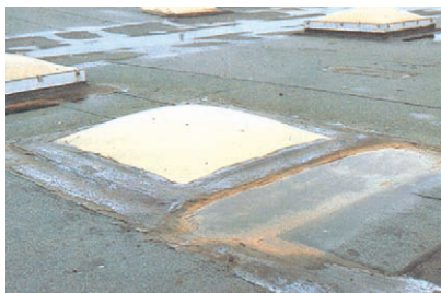
Flere gange forsøgt tætning (foto: BYG-ERFA).
