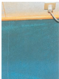
Revner i letbetonelementer (foto: BYG-ERFA)
