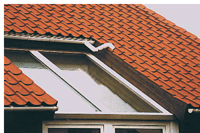
Forkert monteret afløb "Herregårdsvand" (foto: Byggeskadefonden)
