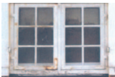
Rustgennemslag på beslag (foto: BYG-ERFA)
