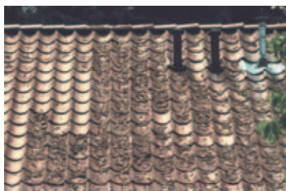
Afskalninger (foto: Byggeskadefonden)
