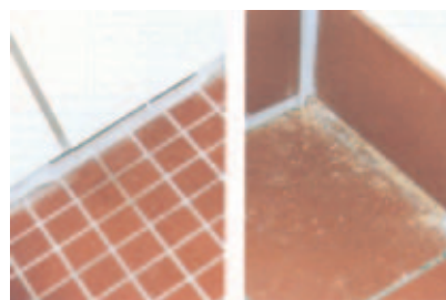
Fugeslip mellem gulv-væg (foto: BYG-ERFA)
