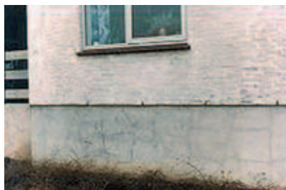
Revner langs blokstenenes fuger (foto: Byggeskadefonden)
