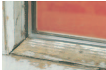
Træoverfladen nedbrudt pga. gråmuld (foto: BYG-ERFA)
