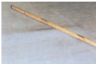
Bulet PVC-belægning (foto: BYG-ERFA)
