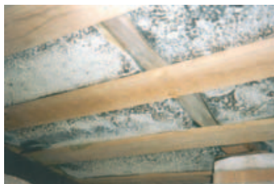
Svamp på undersiden af krybekælderdek (foto: BYG-ERFA)
