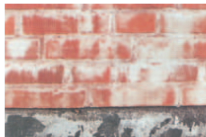
Hvide belægninger (calciumcarbonat) på sokkel og murværk (foto: BYG-ERFA)
