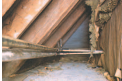
Uisolerede varmerør i skunk (foto: BYG-ERFA)
