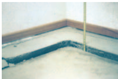
Betonplade i terrænkonstruktion der har sat sig (foto: BYG-ERFA)
