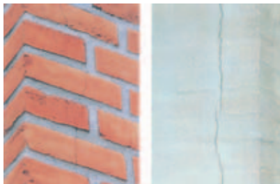
Revner i ydervæg af murværk (foto: BYG-ERFA)
