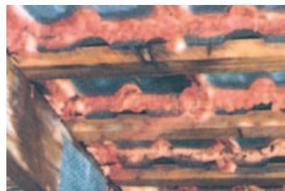
PUR-skum med en blande fejl, der har medført opfugtning af lægter og spær (foto: BYG-ERFA)
