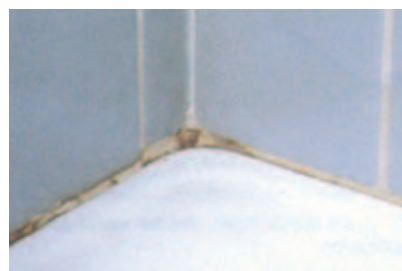
Misfarvet og fugtbelastet fuger (foto: BYG-ERFA)
