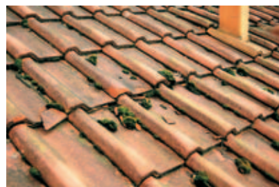
Afskalninger (foto: Byggeskadefonden)
