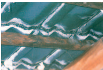
Fugt på undersiden af tagbelægning (foto: BYG-ERFA).
