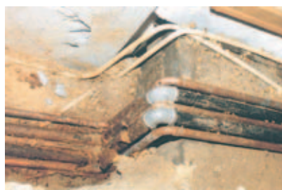
Varme og kolde rør er for tætte på hinanden. Dette medfører ukontrollabel varmeafgivelse og dårlig isolering (foto: BYG-ERFA)
