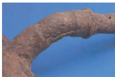
Udvendig korrosion (foto: BYG-ERFA)
