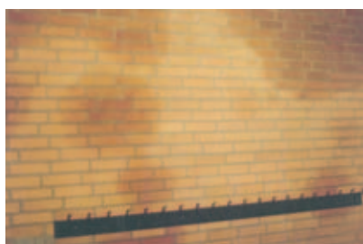
Fugt i formure og skalmure (foto: BYG-ERFA)
