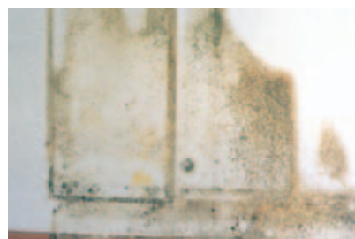
Skimmelvækst på væg i naborum pga. utæt samling gulv-væg i vådrum (foto: BYG-ERFA)
