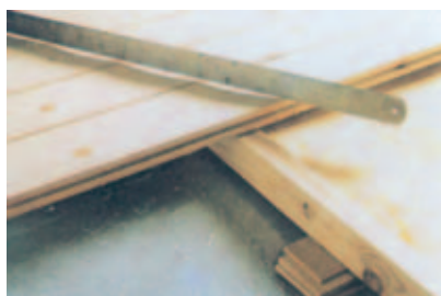
Bræddegulv med "vaskebræt"-overflade (foto: BYG-ERFA)
