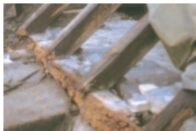
Svampe- og insektangreb i indmuret rem (foto: BYG-ERFA).
