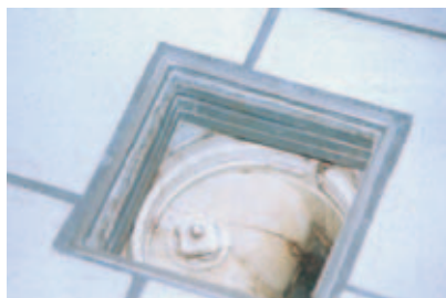
Forkert monteret gulvafløb som led i at et PVC-gulv er ændret til et flisegulv (foto: BYG-ERFA)
