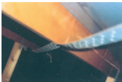
Slappe hulbånd – manglende stabilitet (foto: BYG-ERFA).
