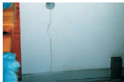
Revnet limfuge ved letbetonelementer (foto: Byggeskadefonden)
