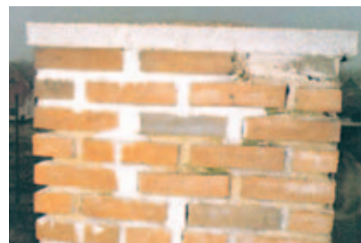
Frostsprængt murværk i skorsten (foto: BYG-ERFA).
