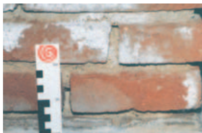
Nedbrudte fuger pga. saltudfældning (foto: BYG-ERFA)
