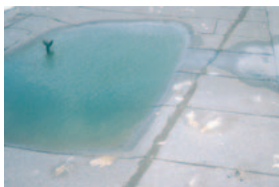
Lunke over svampenedbrudt tagelement (foto: BYG-ERFA).
