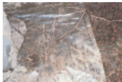
Hussvamp i træfiberplade i terrændæk (foto: BYG-ERFA)
