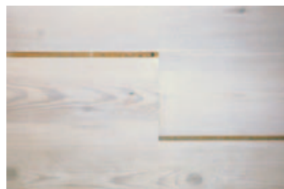
Åbne fuger i trægulv (foto: BYG-ERFA)
