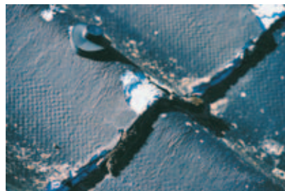
Afskalning (foto: Byggeskadefonden).
