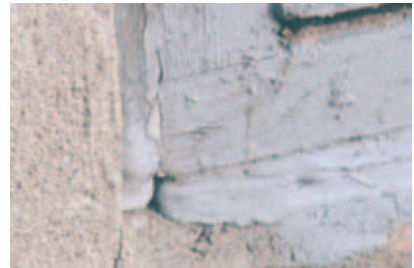
Dårligt udført fugearbejde (foto: BYG-ERFA)
