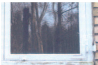
Nedbrudt maling i karmens bundstykke (foto: BYG-ERFA)
