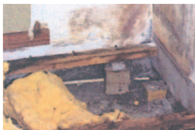
Fugtskade på væg mod badeværelse (foto: BYG-ERFA)
