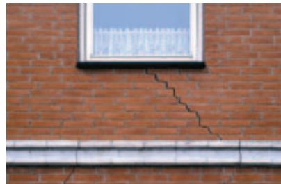
Revner i ydervæg af murværk (foto: Byggeskadefonden)
