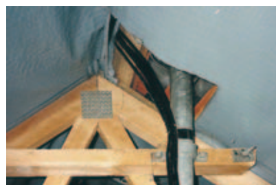
Forkert udført rørgennemføring (foto: BYG-ERFA).
