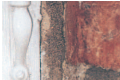
Fugeslip i mørtelfuge (foto: BYG-ERFA)
