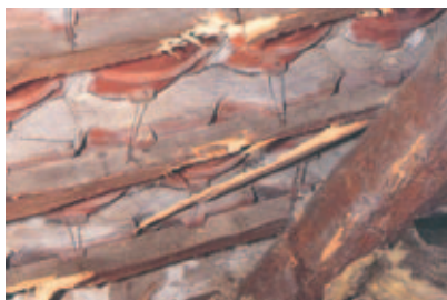
Husbukke i tagkonstruktion (foto: BYG-ERFA).
