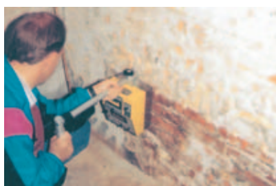
Afskalning af puds og maling (foto: BYG-ERFA)
