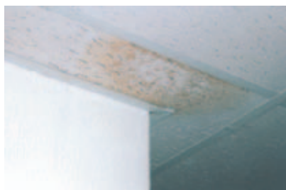
Fugtplet på nedhængt loft (foto: BYG-ERFA)
