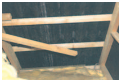
Fejlplaceret skrålægte – manglende stabilitet (foto: BYG-ERFA).
