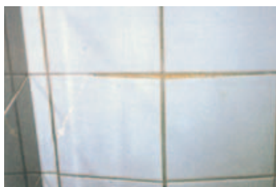
Løstsiddende fliser (foto: BYG-ERFA)
