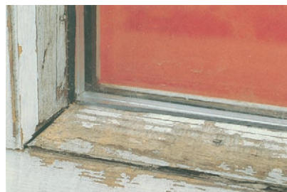
Træoverfladen nedbrudt pga. gråmuld (foto: BYG-ERFA)
