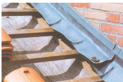
Undertag af dug der "hænger" for meget (foto: BYG-ERFA).
