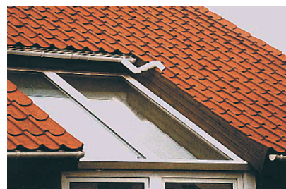
Forkert monteret afløb "Herregårdsvand" (foto: Byggeskadefonden)
