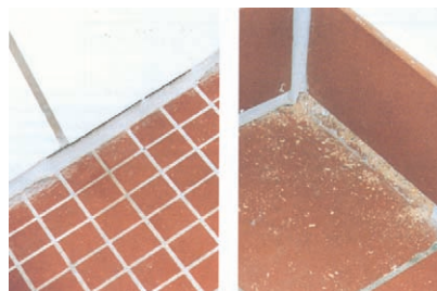
Fugeslip mellem gulv-væg (foto: BYG-ERFA)
