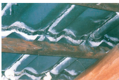
Fugt på undersiden af tagbelægning (foto: BYG-ERFA).
