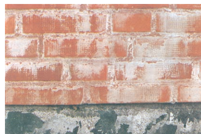
Saltudblomstring (calciumcarbonat) på murværk (foto: BYG-ERFA)
