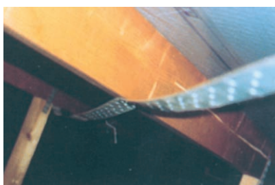
Slappe hulbånd – manglende stabilitet (foto: BYG-ERFA).
