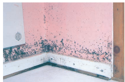
Skimmelangreb på pudset og malet indv. væg (foto: BYG-ERFA)
