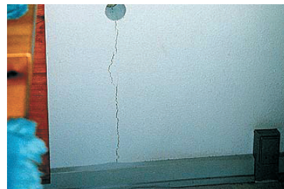
Revnet limfuge ved letbetonelementer (foto: Byggeskadefonden)
