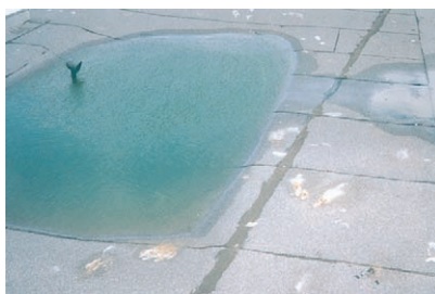
Lunke over svampenedbrudt tagelement (foto: BYG-ERFA).
