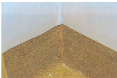
Defekt udført og utæt svejsefuge (foto: BYG-ERFA)
