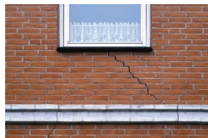
Revner i ydervæg af murværk (foto: Byggeskadefonden)
