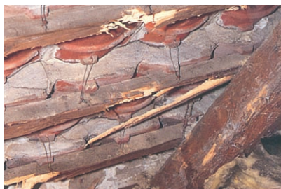
Husbukke i tagkonstruktion (foto: BYG-ERFA).
