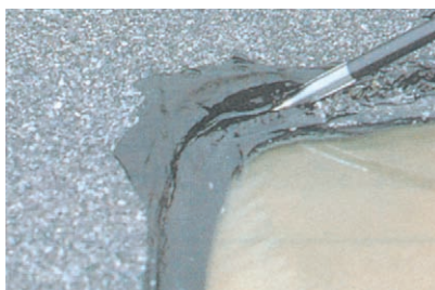
Utæt hjørnesamling (foto: BYG-ERFA).
