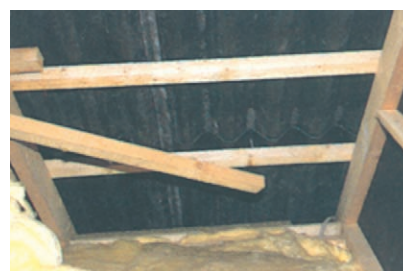
Fejlplaceret skrålægte – manglende stabilitet (foto: BYG-ERFA).
