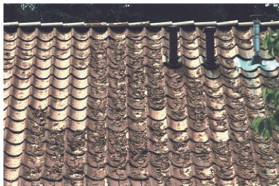
Afskalninger (foto: Byggeskadefonden)
