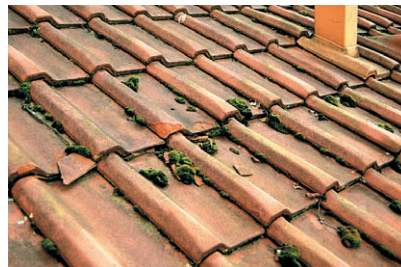
Afskalninger (foto: Byggeskadefonden)
