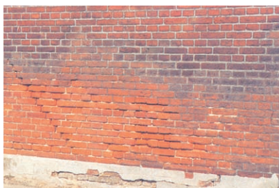
Forvitret murværk (foto: BYG-ERFA)
