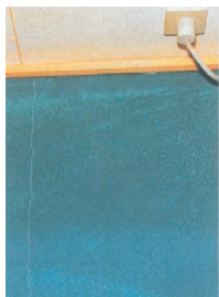
Revner i letbetonelementer (foto: BYG-ERFA)
