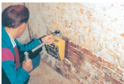
Afskalning af puds og maling (foto: BYG-ERFA)
