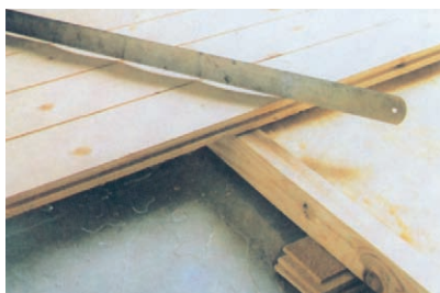
Bræddegulv med "vaskebræt"-overflade (foto: BYG-ERFA)
