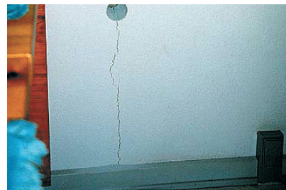
Revnet limfuge ved letbetonelementer (foto: Byggeskadefonden)
