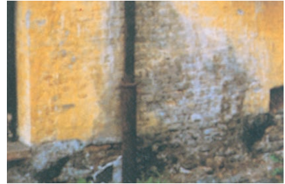
Utæt nedløbsrør (foto: BYG-ERFA)
