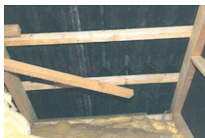
Fejlplaceret skrålægte – manglende stabilitet (foto: BYG-ERFA).
