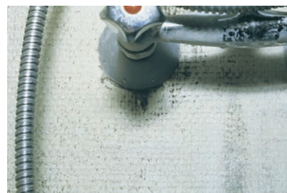
Skimmel på malerbehandlet gipsplade omkring blandingsbatteri (foto: BYG-ERFA)
