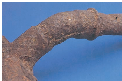
Udvendig korrosion (foto: BYG-ERFA)
