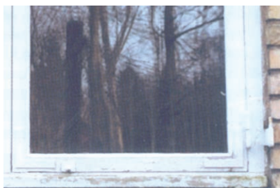
Nedbrudt maling i karmens bundstykke (foto: BYG-ERFA)
