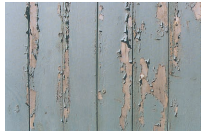
Afskallet maling pga. litapone-holdig maling (foto: BYG-ERFA)
