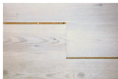
Åbne fuger i trægulv (foto: BYG-ERFA)
