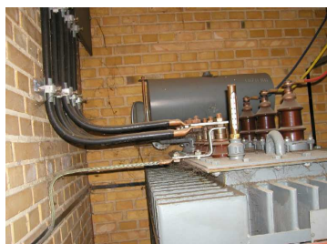
Beskyttelse mod direkte berøring ved placering i aflåst stationsrum. Lavspænding
